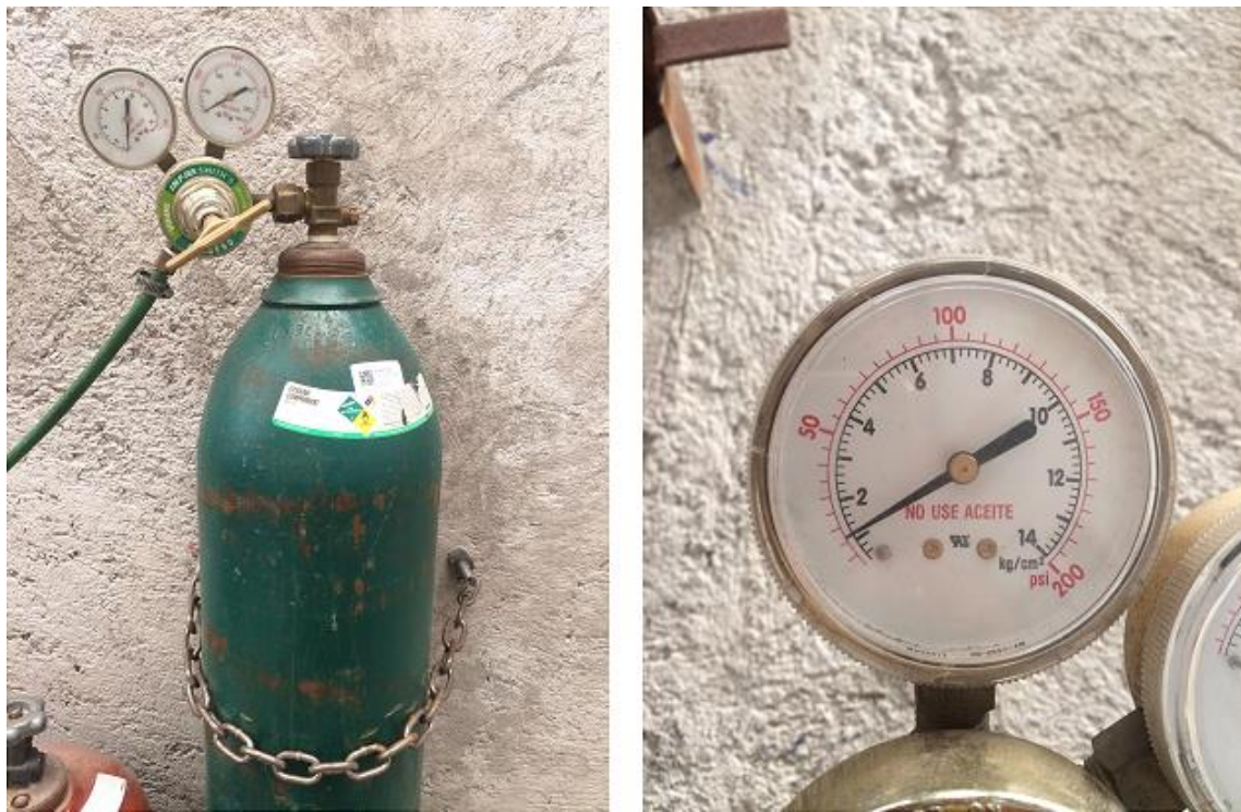
Fig. 2.10. Presión adecuada para el tanque de oxígeno.
