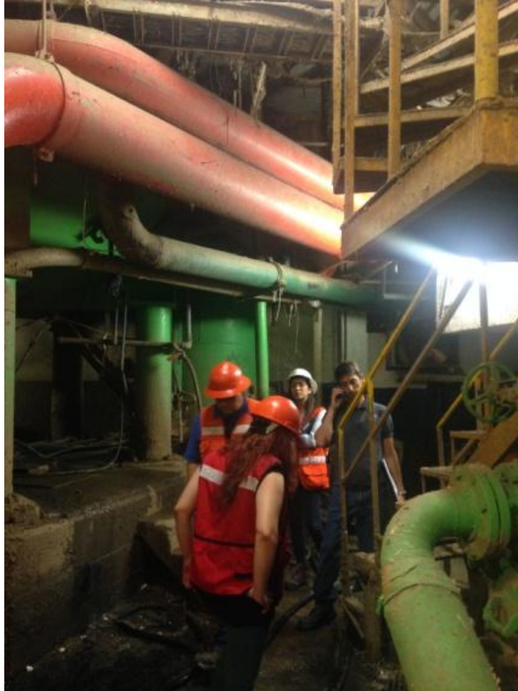
Figura 25. Área de Bombas
