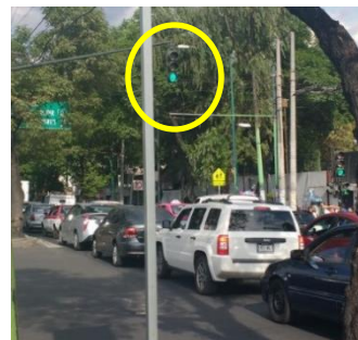
Fotografía 9. Semáforos como sistema de control
