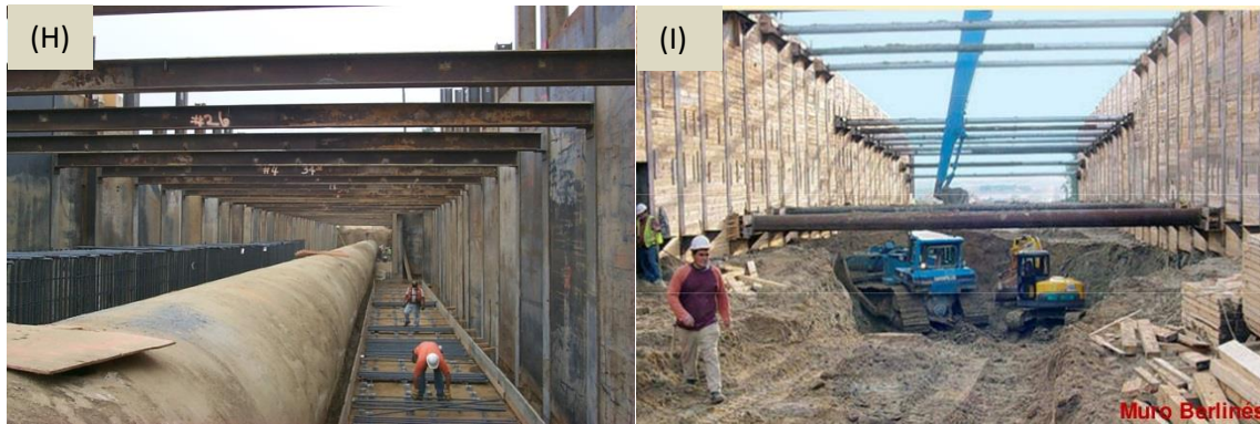
Figura 3.2.1d – (H) “Cut and Cover” para la construcción de túneles de transporte de agua potable por medio de tuberías con largueros de concreto entre los perfiles IR y troqueles, (I) “Cut and Cover” para la construcción de portales de túneles con muro Berlín y troqueles.
