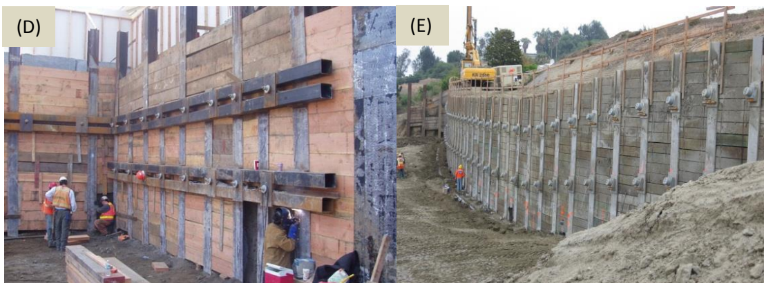
Figura 3.2.1b – (D) “Cut and Cover” para la construcción de estaciones subterráneas por medio de muro Berlín anclado, (E) “Cut and Cover” para construir pasos a desnivel en autopistas por medio de Muro Berlín anclado.
