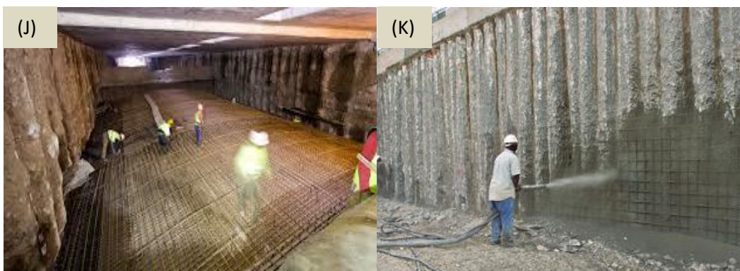
Figura 3.2.1e – (J) “Cut and Cover” para la construcción de túneles carreteros urbanos con pilas secantes, (K) Cut and Cover” para la construcción de túneles carreteros urbanos con pilas secantes y concreto lanzado reforzado.
