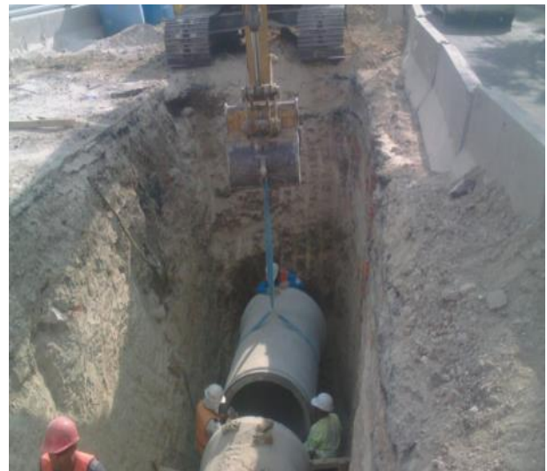
Ilustración 15. Colocación de tubería de concreto reforzado, posterior a la colocación de cama de arena, Espíndola A. 2017.
