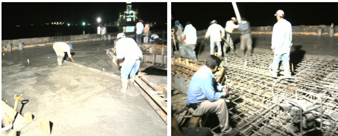
Imagen No.131.- Continuando con el colado en la trabe T-4 y losa en el eje G del eje 5 al 13, y del eje 13 desde G a D, terminando el colado de la trabe T-4.
