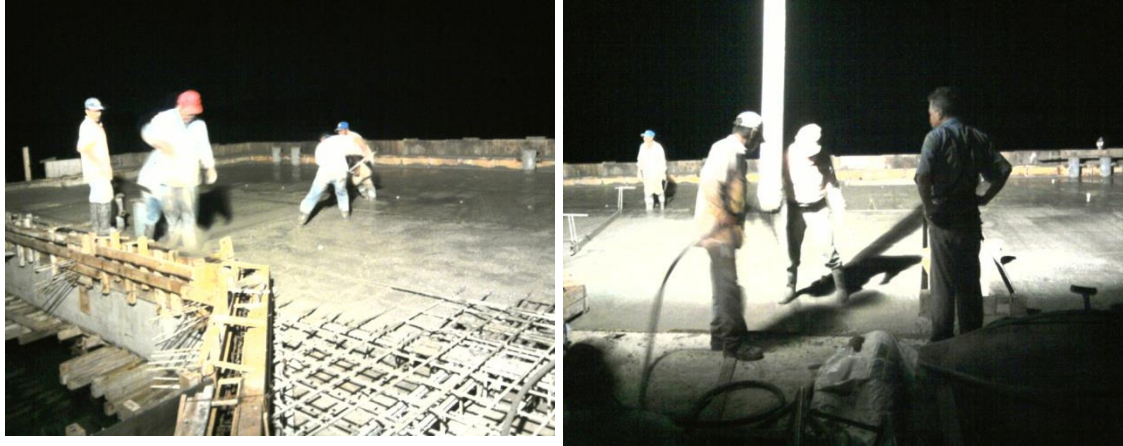
Imagen No.132.- Colado de la trabe T-4 y losa del muelle en el eje G del eje 5 al 13 y del eje 13 desde G a D.
