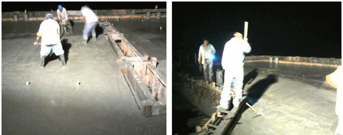
Imagen No.133.- Terminación de los colados de la trabe T-4, guarniciones y losa del muelle, con acabado pulido.
