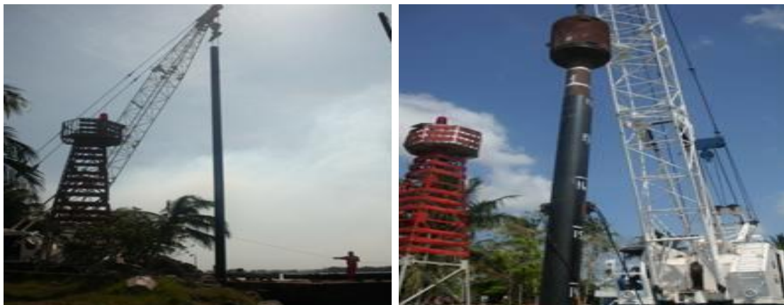
Imagen No.52.- Izado e hincado de los pilotes con pilón (5.235Ton.), para la cimentación de la trabe T-10.
