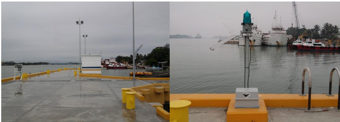
Imagen No.193.-Acometida eléctrica para la iluminación del muelle para el Buque Oceanográfico.
