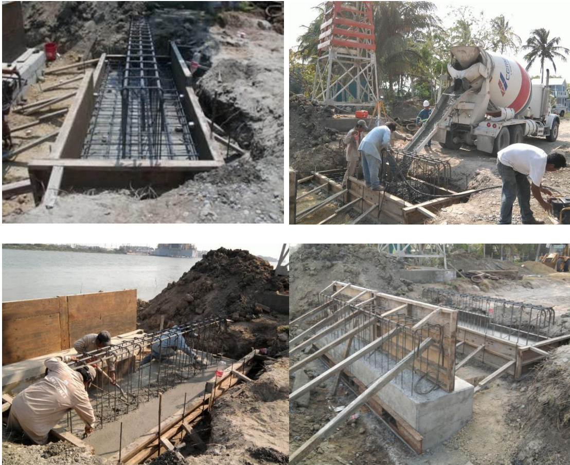
Imágenes No.61.-Acero, cimbra y colocación de concreto a tiro directo, a nivel de la zapata de la trabe de la rampa de acceso al muelle.
