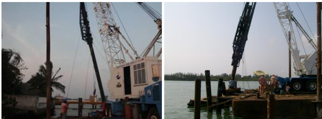
Imagen No.93.- Hincado del primer tramo del pilote inclinado (PI-28) con el martillo hasta dejarlo un metro fuera del mar, para el acoplamiento del segundo tramo.
