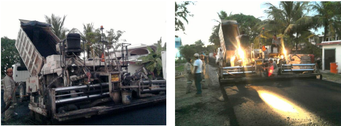
Imagen No.174.-Suministro y colocación de la carpeta asfáltica de 10cm de espesor, aplicada con camión volteo y pavimentadora sobre el camino de acceso al muelle.
