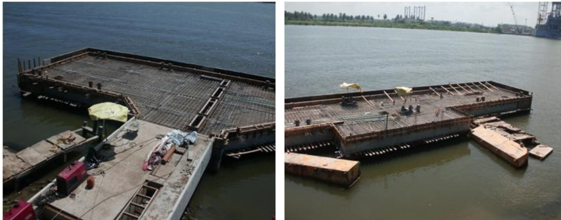
Imagen No.125.- Superficies limpias y preparadas para colar la losa, guarniciones y trabe T-4 (pantalla de atraque) del muelle.
