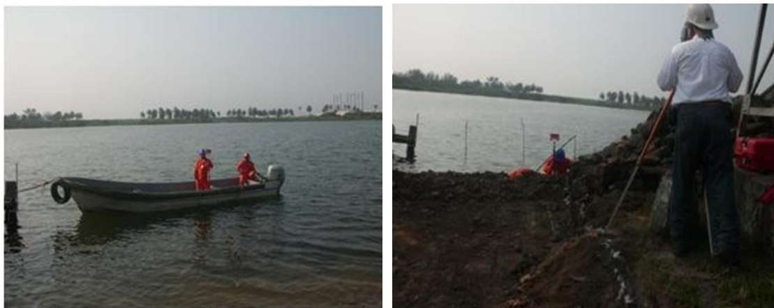
Imagen No.28.- Trazo y Posición de Pilotes en el río con Estación Total y GPS. 2.2.- Batimetría.
