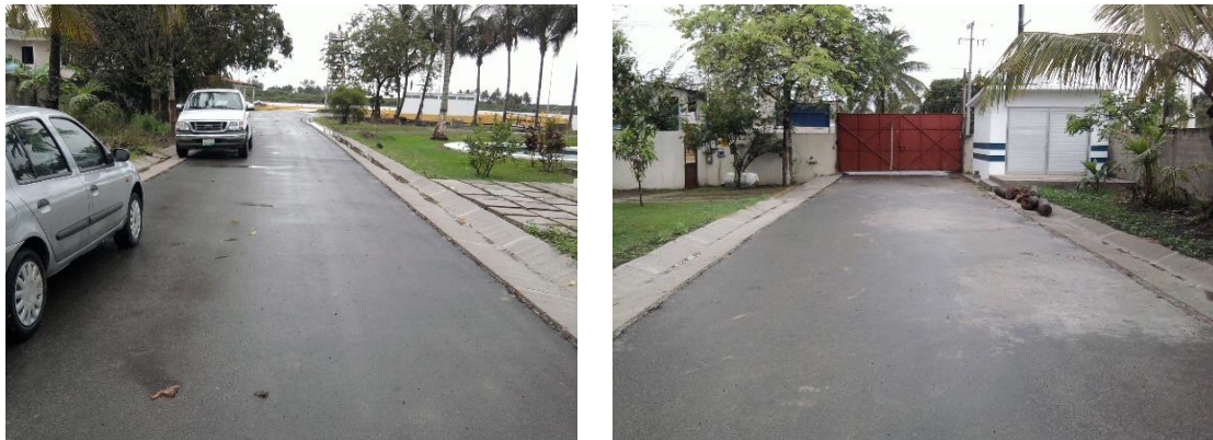
Imagen No.181.-Limpieza del pavimento asfáltico y cunetas de concreto ya terminados a lo largo del camino de acceso al muelle.
