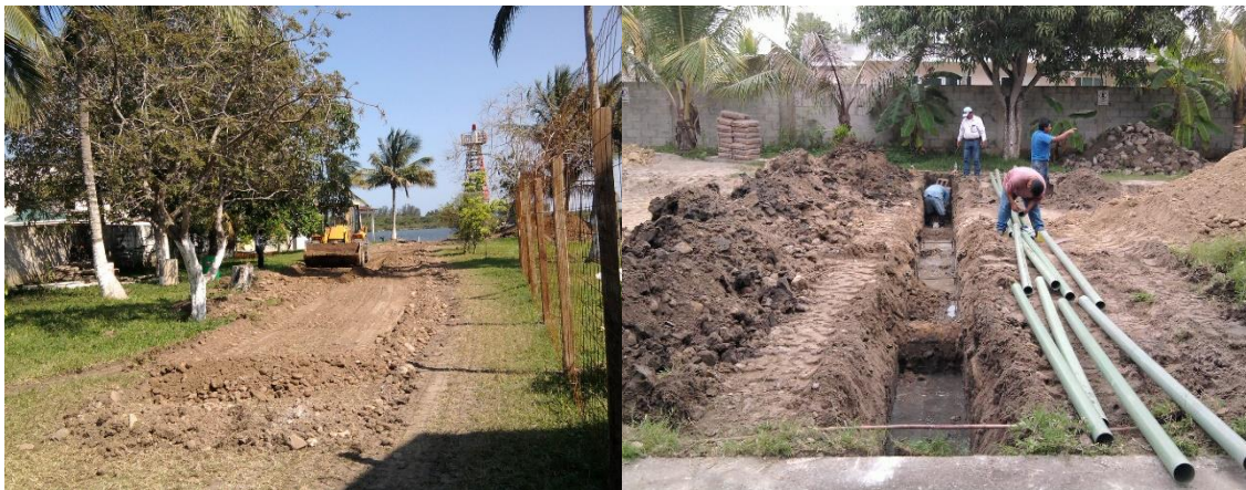
Imagen No.35.- Despalme, excavación y cruces canalizaciones eléctricas en el camino acceso al muelle con la retroexcavadora.
