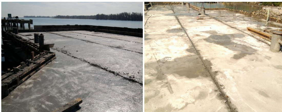
Imagen No.135.- Curado a base de riego de arena y agua en la trabe T-4, guarniciones y losa del muelle.
