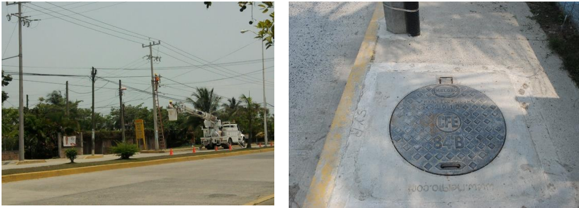
Imagen No.195.-Acometida aérea desde un poste de la red de suministro CFE, a un registro frete a la caseta de la subestación eléctrica del predio de la Base de Operaciones Oceanográficas del Buque Oceanográfico de la UNAM.
