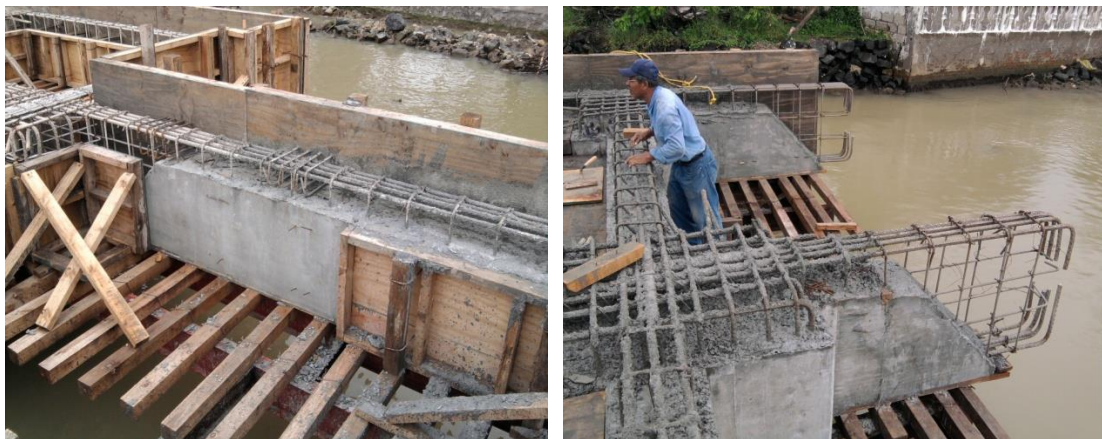
Imagen No.109.- Descimbrado de los tapones en traveses de los ejes 13, 12, 11 y 7 entre ejes D a G, tramos pendientes para continuar con los armados y colar monóticamente con la trabe (T-4) pantalla.
