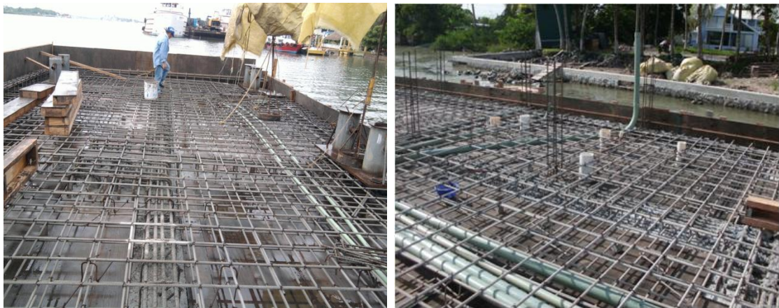
Imagen No.123.- Colocación de bitas dobles, tuberías para las instalaciones eléctricas, y acero de refuerzo para la losa del muelle. Terminado los trabajos anteriores, la supervisión interna ordena a la externa y a la contratista, que se tendrán que colocar antes de realizar el colado de la losa, unos drenes pluviales a base de tubería de PVC hidráulico de 2" pulgadas diámetro y 0.30 metros longitud a instalarse en losa al centro de los ejes D-E, E-F y F-G a lo largo y entre los ejes del 1 al 13 a cada metro en ambos sentidos, dentro de las trincheras a lo largo a cada metro de muelle (por nota de bitácora), ver imagen No.124.
