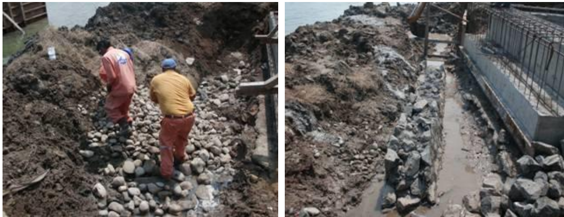
Imagen No.69.- Relleno de piedra limpia de río (piedraplen), base de desplante del muro de contención.
