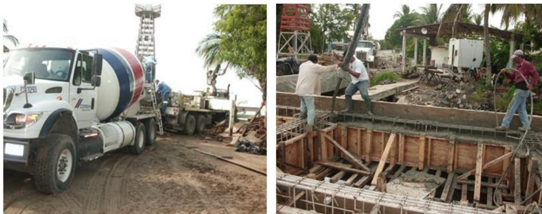
Imagen No.107.- Suministro y colocación de concreto premezclado en cabezales y traveses, entre los ejes 13, 12, 11, y 7 del eje D a G, del muelle en el río.
