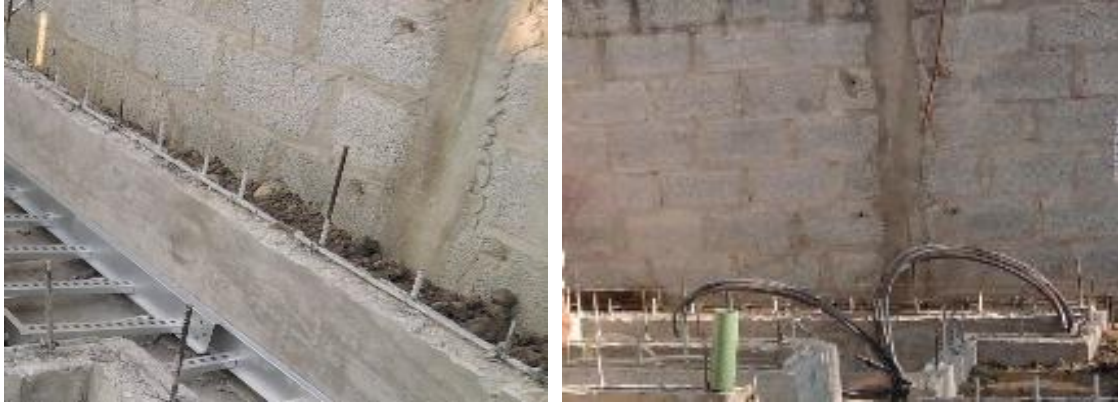
Imagen No.185.- Castillos y muros de block hueco de concreto de la caseta de la subestación eléctrica.
