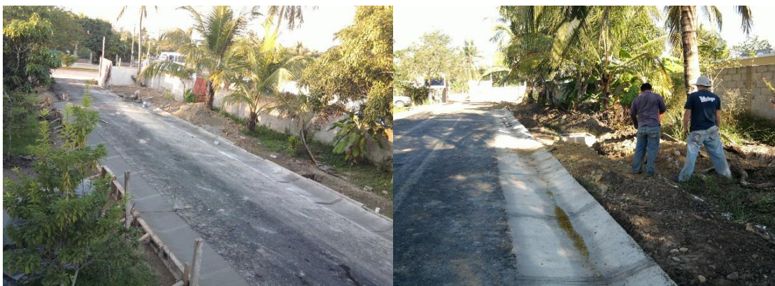
Imagen No.188.- Trazos y niveles de las cepas para las canalizaciones eléctricas, para la acometida de la subestación eléctrica al muelle.
