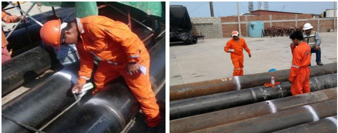
Imagen No.41.- Prueba de líquidos penetrantes en cordones de soldadura en la unión de pilotes.
