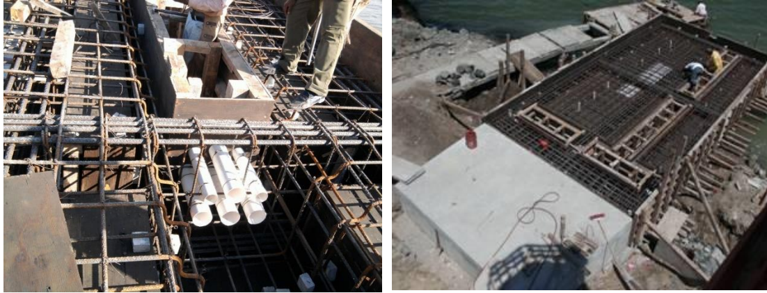
Imagen No.80.- Construcción de trincheras para paso de las instalaciones a base de tuberías de PVC y ángulo estructural, en la construcción de la pasarela de acceso al muelle en río.
