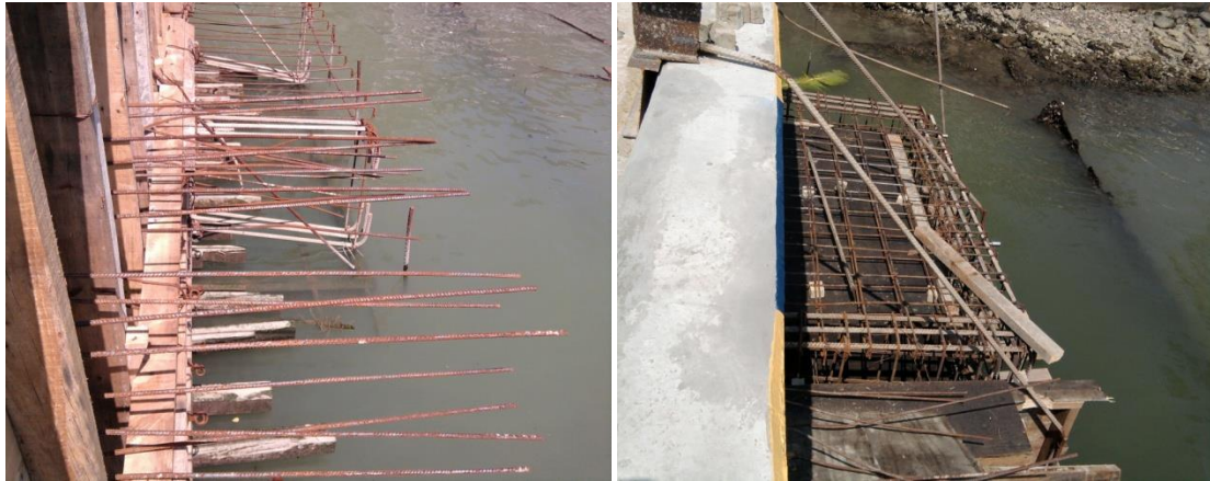
Imagen No.136.- Acero de refuerzo y cimbra común para la construcción de las trabes (T-1), losa y escalera, para el muelle de lanchas.
