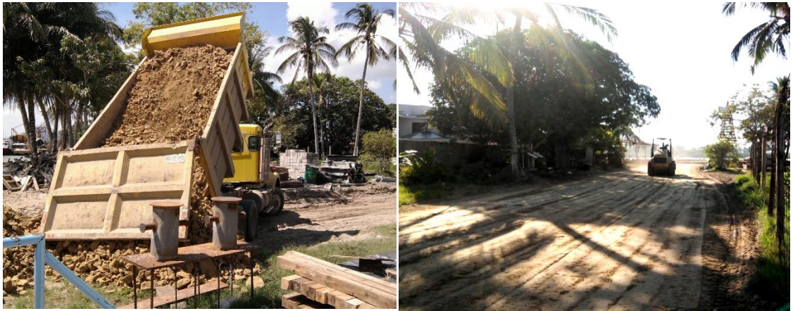
Imagen No.37.- Suministro, colocación y compactación de tepetate que forman el mejoramiento del camino de acceso al muelle.
