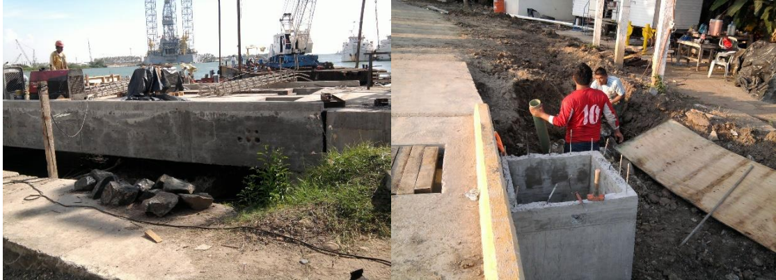
Imagen No.193.-Canalizaciones para las acometidas eléctricas de la iluminación del muelle, equipos de la caseta contra incendios, y para el contacto de toma de corriente del buque oceanográfico.
