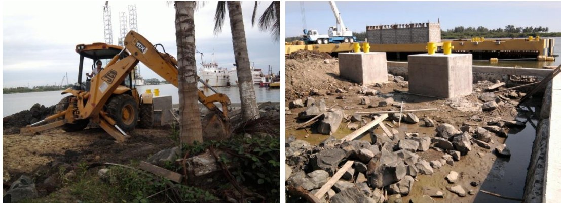
Imagen No.159.-Conformación del muro de contención (tarquina) en tierra, para contener el material producto del dragado del río Tuxpan.
