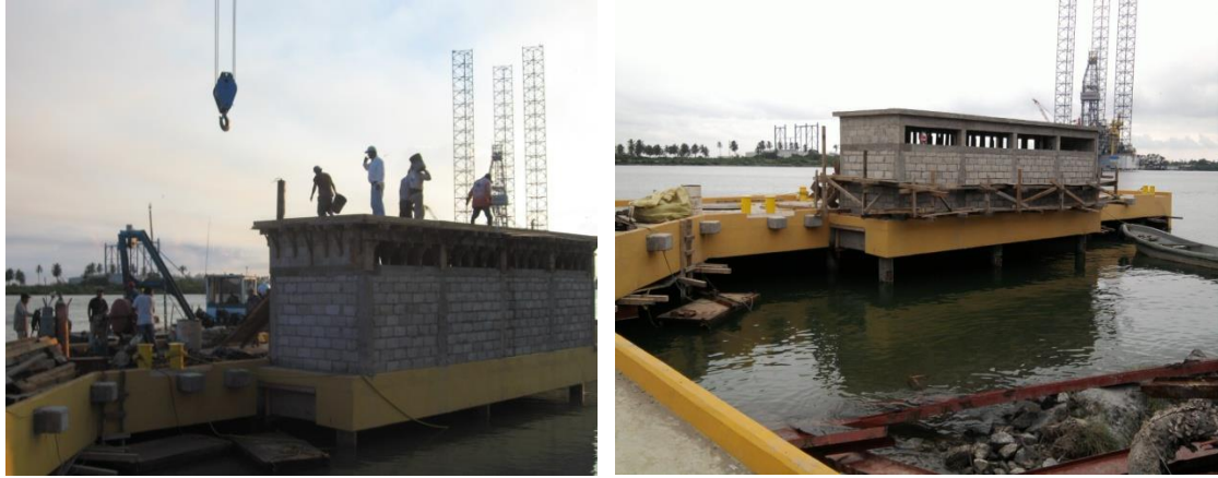
Imagen No.140.- Cimbra, acero de refuerzo y colado de losa de azotea de concreto, en la caseta de sistema contra incendios.
