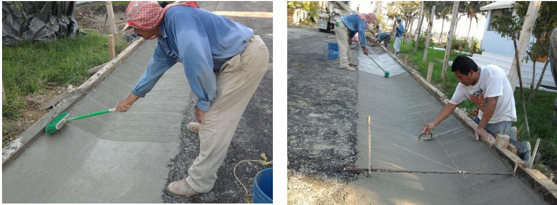
Imagen No.180.-Escobillado y elaboración de juntas de contracción en las cunetas del camino de acceso al muelle.
