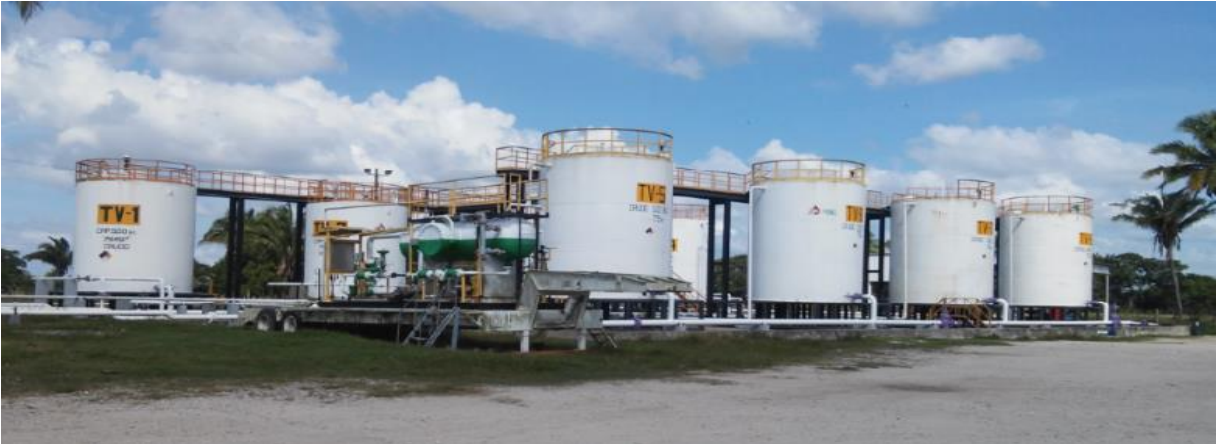
Figura 10 Tanques de Almacenamiento, Activo 5P, Agua Dulce, Ver.
