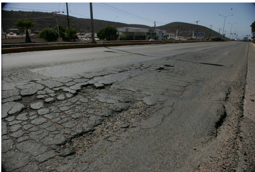
Figura 2 – Ejemplo de pavimento de estructura flexible con falla generalizada mecánica y funcional.
