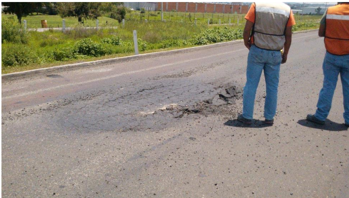
Figura 60 – Ejemplo de bache de rápido desarrollo en zona previamente rehabilitada con sobre carpeta.
