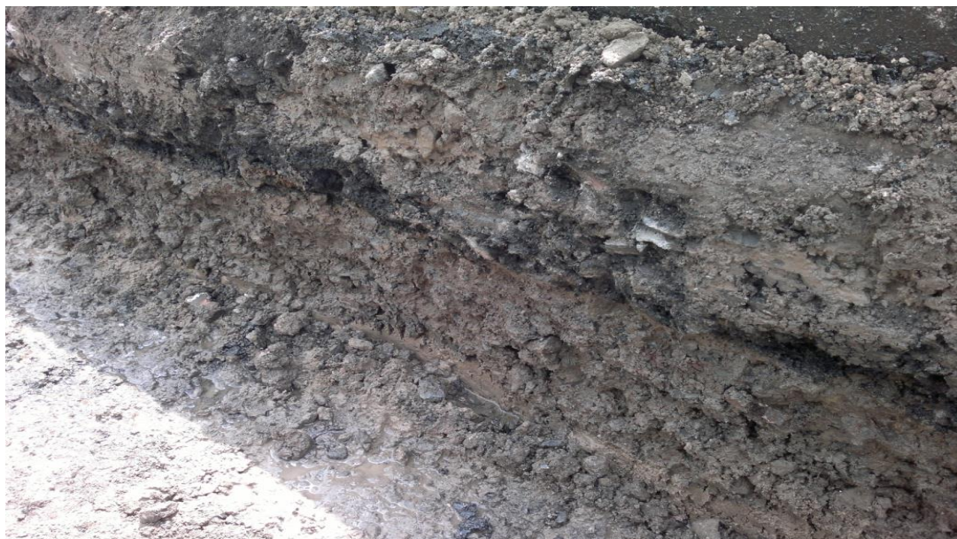
Figura 41 – Saturación y escurrimiento de agua a nivel de subbase y terracerías, septiembre de 2012.
