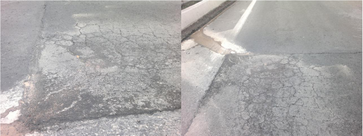
Figura 33 – Borde de zona bacheada fracturada con escurrimientos y pérdida de finos, agosto de 2012.
