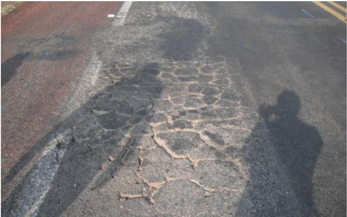
Figura 26 – Carpeta asfáltica km 51+200, abril de 2012.
