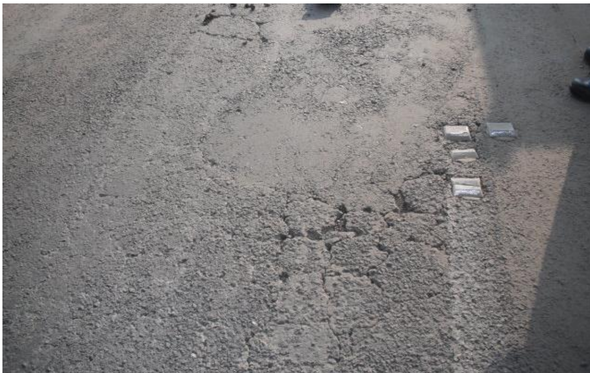
Figura 27 – Carpeta asfáltica km 51+250, abril de 2012.
