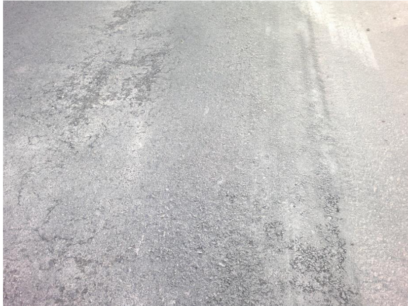
Figura 32 – Carpeta asfáltica con grietas y atrición 3 meses después de rehabilitada, agosto de 2012.
