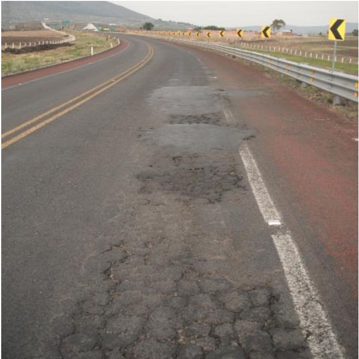
Figura 28 – Carpeta asfáltica km 52+600, abril de 2012.
