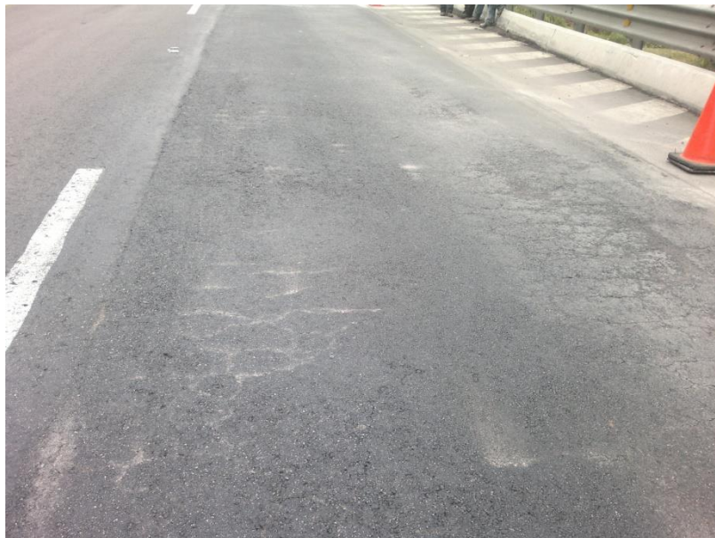
Figura 31 – Carpeta asfáltica con piel de cocodrilo apenas 3 meses después de rehabilitada, agosto de 2012.
