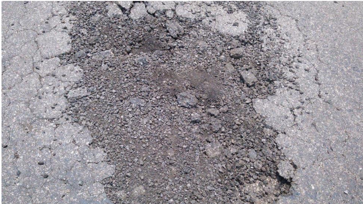
Figura 61 – Detalle de la zona con hundimiento, fisuración intensa, expulsión de finos y bache.
