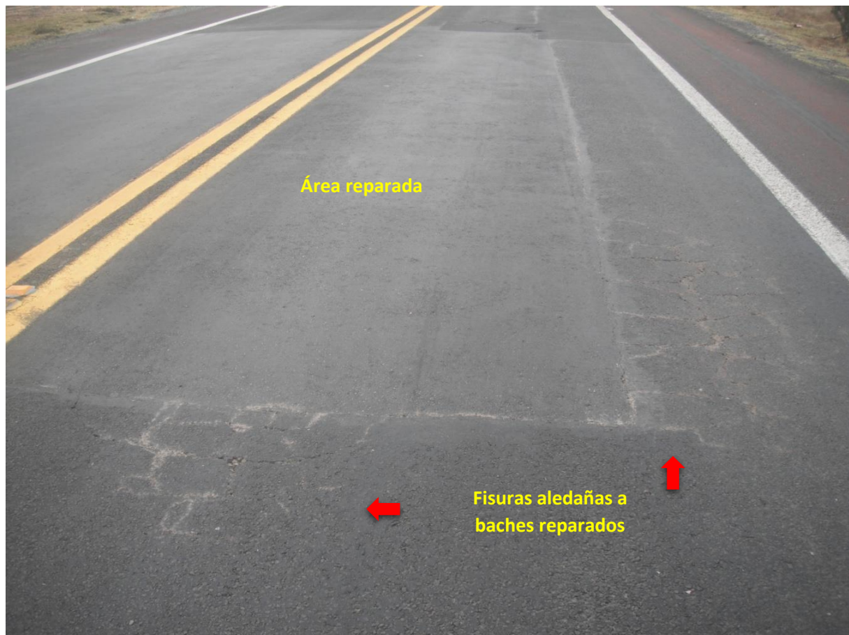
Figura 64 – Zona de bacheo profundo limitando con zona de degradación acelerada.
