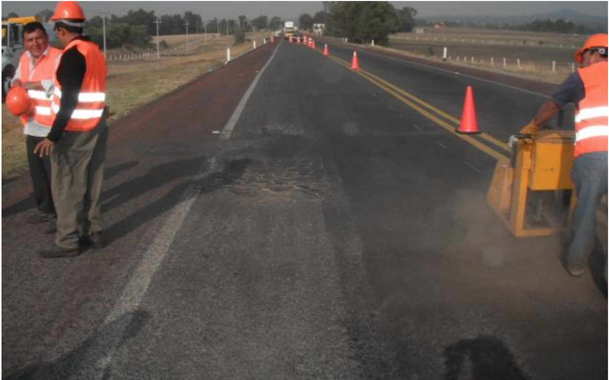
Figura 50 – Ejemplo de zona de pavimento a rehabilitar con bacheo profundo y sobreespesor de carpeta.
