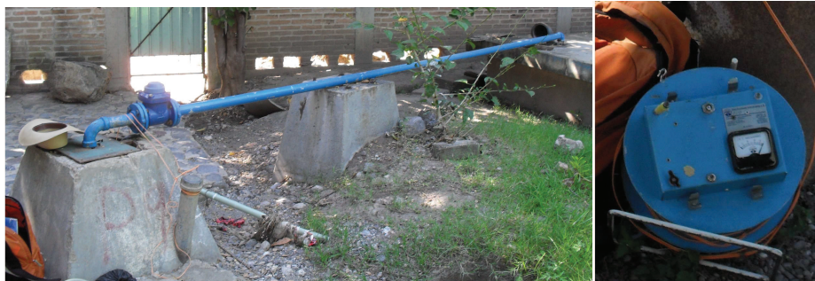
Figura 26. Pozo de bombeo número 9 y Sonda.
