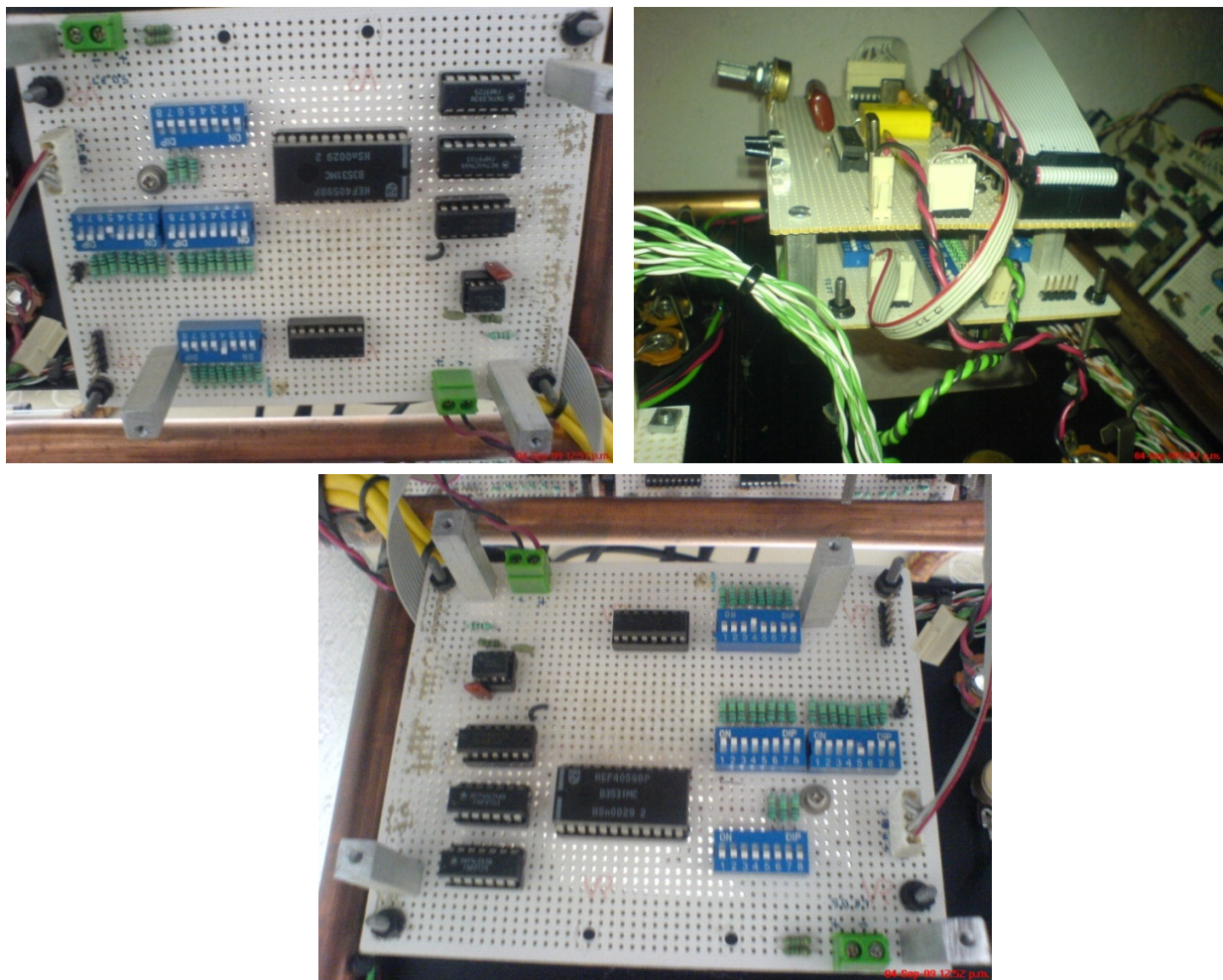
Figura 5.20 Sección de Control del Panel.
