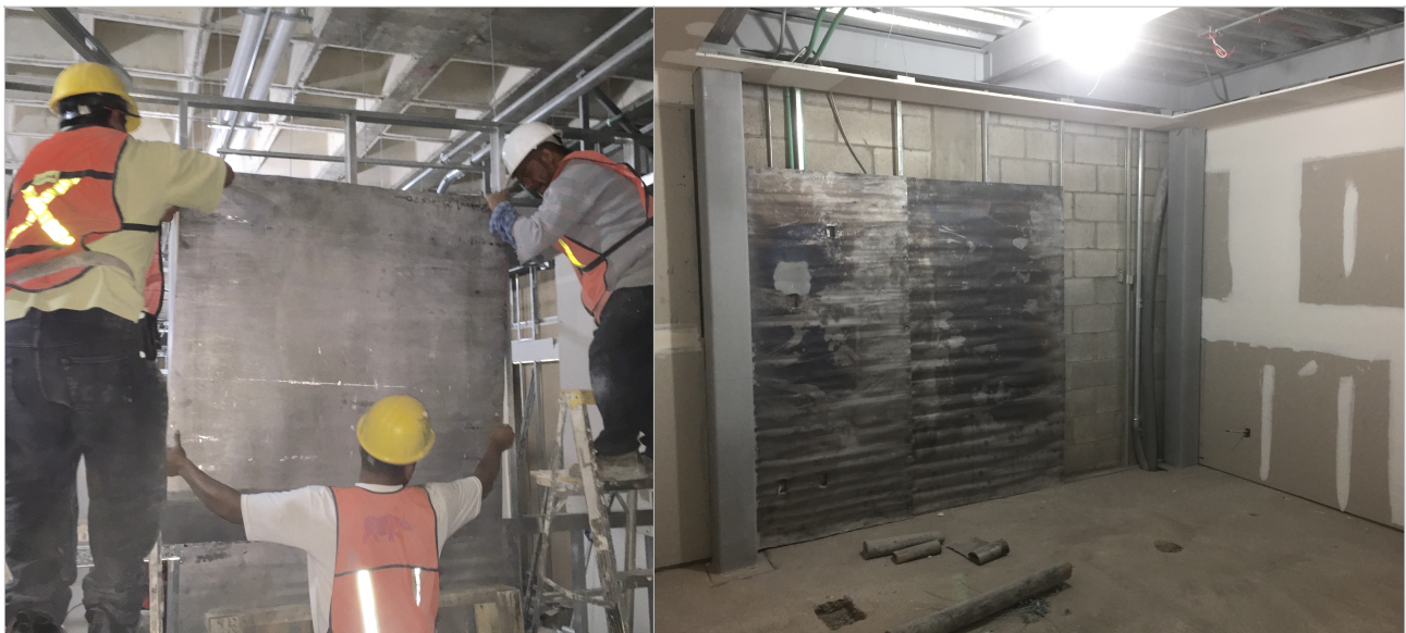
Figura 2.3 Blindaje de áreas con láminas de plomo
