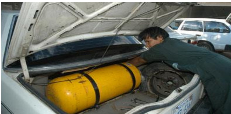
Figura2.14: Foto de la instalación de un tanque de gas a un automóvil Sacada de: http://www.bolivia.com/actualidad/nacionales/sdi/53883/entidad-de-conversion-transformo-30477-coches-a-gnv-en-2012
