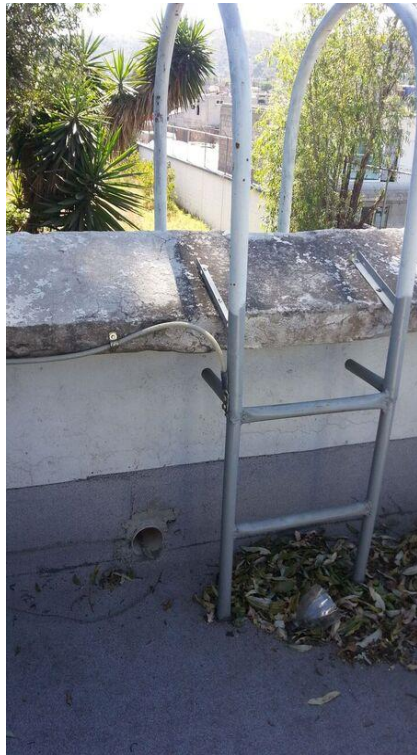
Figura 4.4a Conductor de puesta a tierra de estructuras metálicas y carcasas en azotea.
