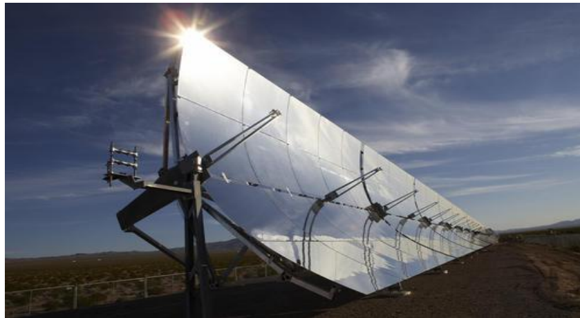
Figura 1.2. Celdas termosolares en un campo solar, Nevada, EUA.
