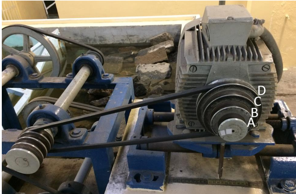
Figura 3.3.4 Poleas adosadas el motor del estanque de olas
