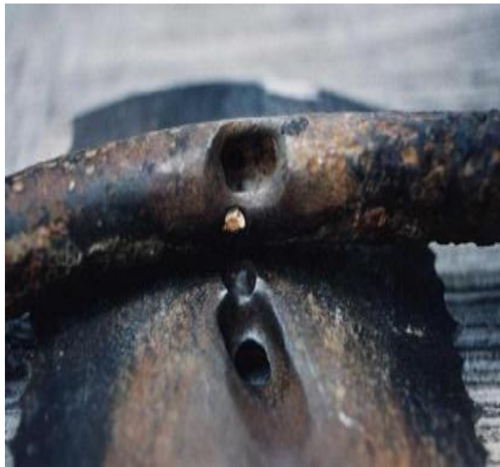
FIGURA 24. CORROSIÓN ENTRE LÍNEAS DE AGUA Y GASODUCTO DE LA EXPLOSIÓN EN GUADALAJARA JALISCO.
