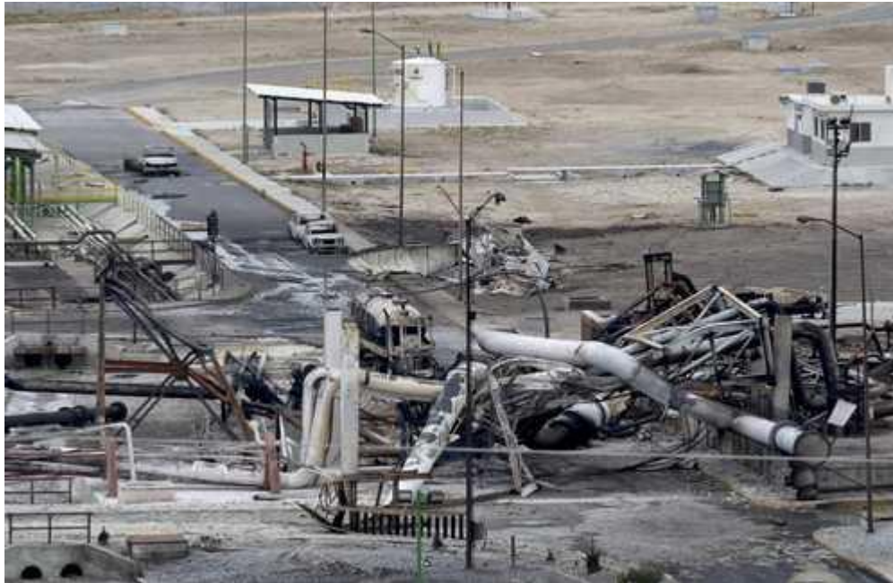
FIGURA 25. EXPLOSIÓN EN EL GASODUCTO DE REYNOSA TAMAULIPAS, LA JORNADA.
