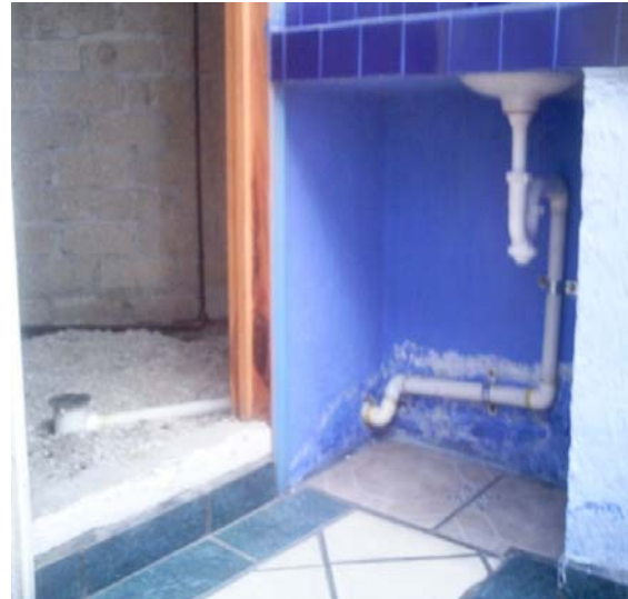
Figura 2.3 Separación de agua gris en lavabos
