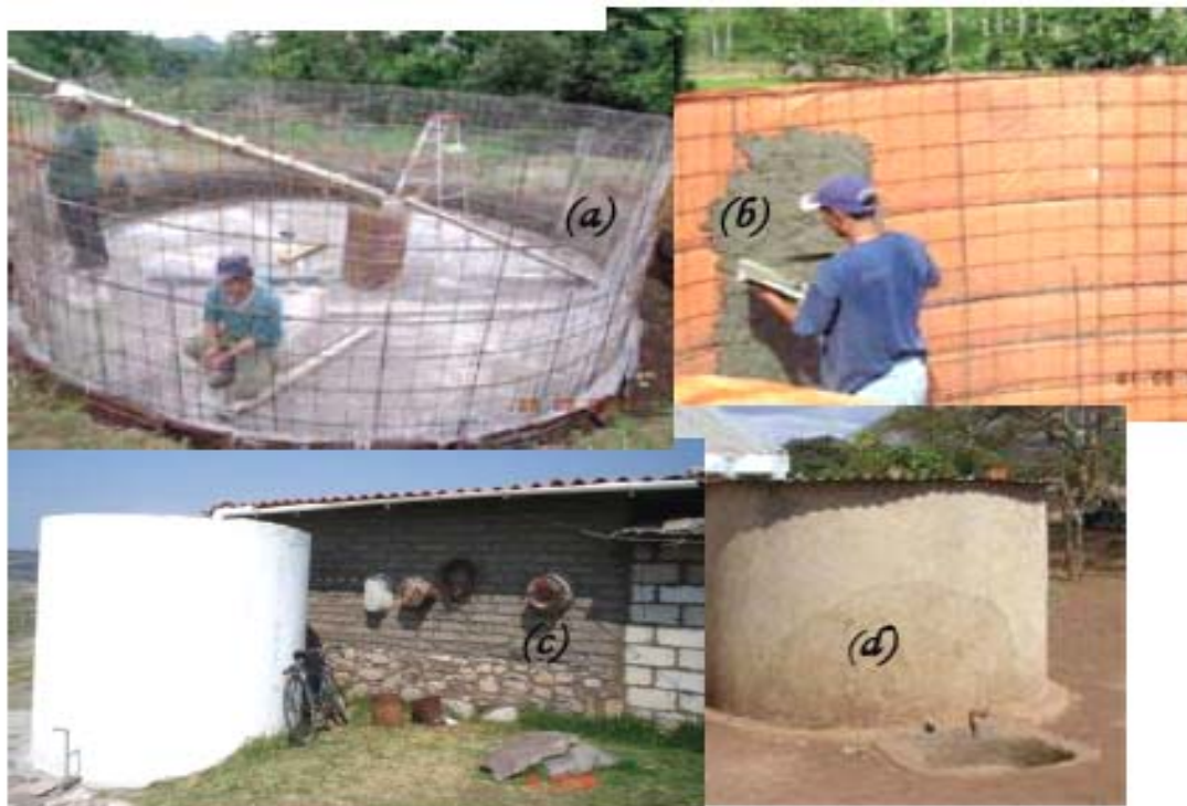
Figura 3.6 Depósito o cisterna de ferrocemento
