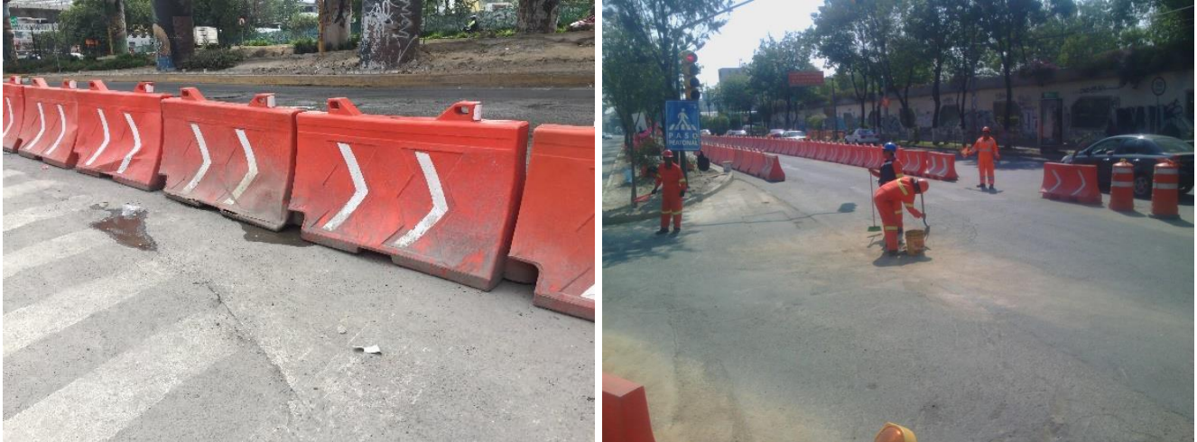
Figura 19 Barreras fijas colocadas en serie usadas para canalizar tránsito
