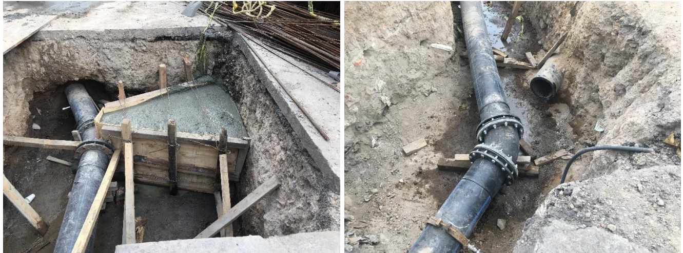
Figura 29 Tubería de agua potable de 12"
