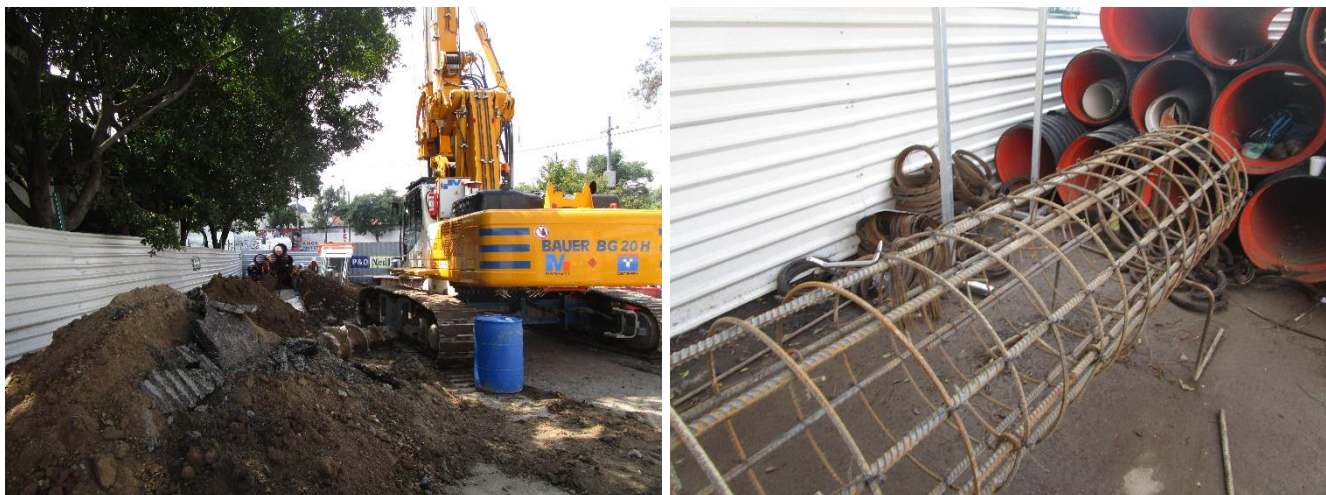
Figura 36 Armado de las pilas de concreto en el perímetro de caja de conexión CC-02
