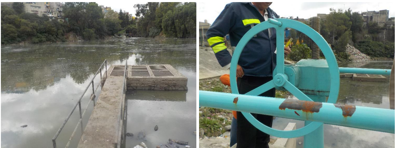
Figura 82 Cierre de compuertas de la presa
