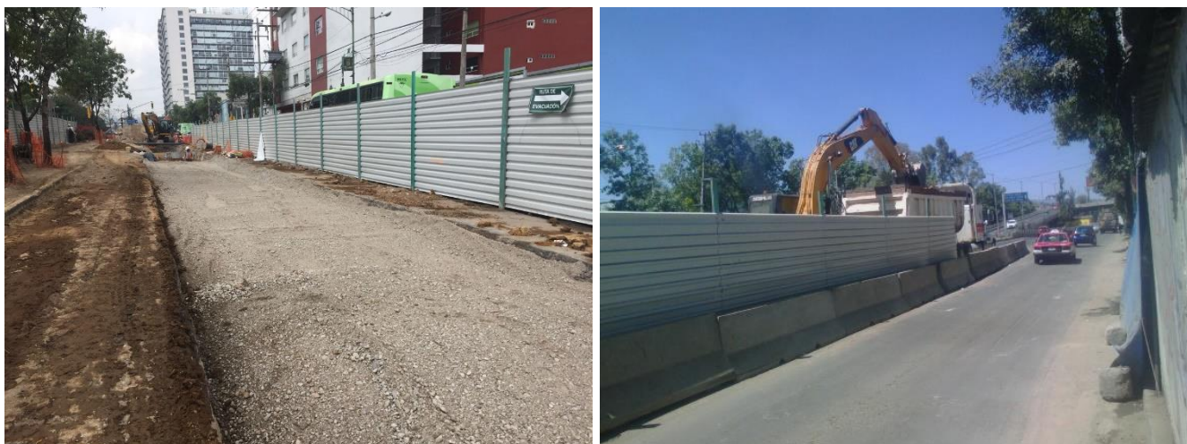
Figura 22 Zona de obra confinada con tapial y barreras de concreto desde CD-03 a PC-04'
