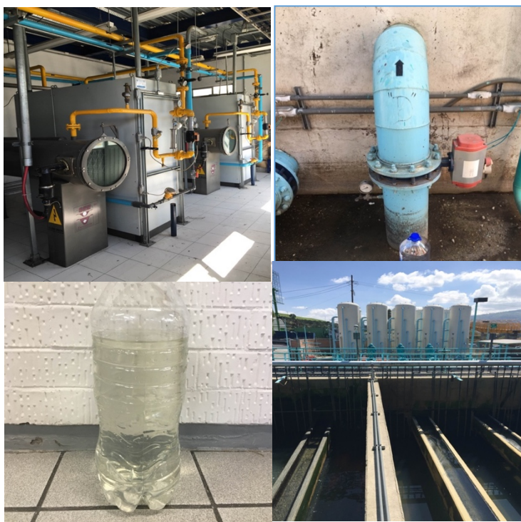
Figura 5.9. Imágenes de la planta de tratamiento “La caldera”
