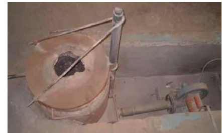
Figura 8. Horno de gas de la Facultad de Ingeniería
