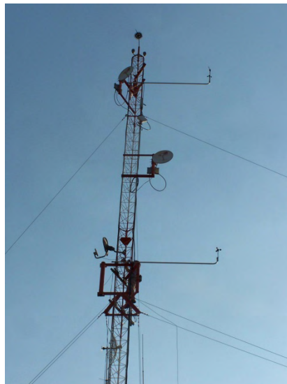
Fig. 3. 18 Vista con los sensores instalados
