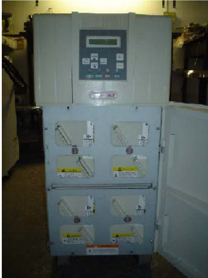
Figura 10.2 Gabinete de baterías del UPS serie 1600
