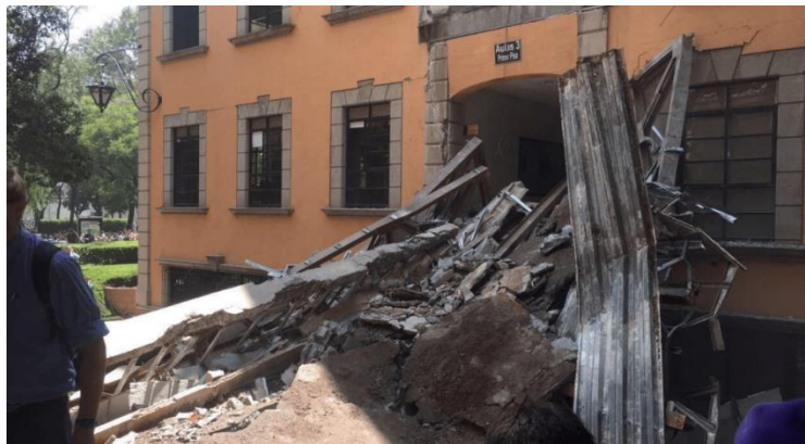
Fig. I.12 Puente del Tec de Monterrey campus CDMX colapsado (Imagen de "El Arsenal")
