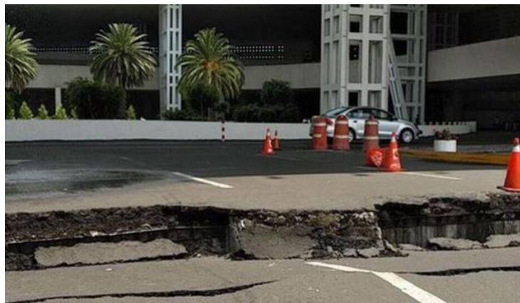
Fig. I.14 Grieta en la entrada de la Terminal 2 del AICM provocada por el sismo( Imagen de "zocalo.com.mx")
