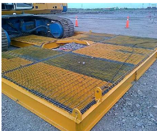
FIGURA 36-37. Dispositivo de seguridad para plataforma de trabajo del personal. “ICA Dirección de Puertos, agua y minería (2014), Documento 1205 TECII-CON-PTC-001, Rev. 03, p.p. (7).”
