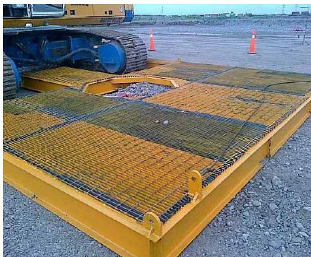
FIGURA 137. Dispositivo de seguridad para plataforma de trabajo del personal. “ICA Dirección de Puertos, agua y minería (2014), Documento 1205 TECII-CON-PTC-001, Rev. 03, p.p. (7).”
