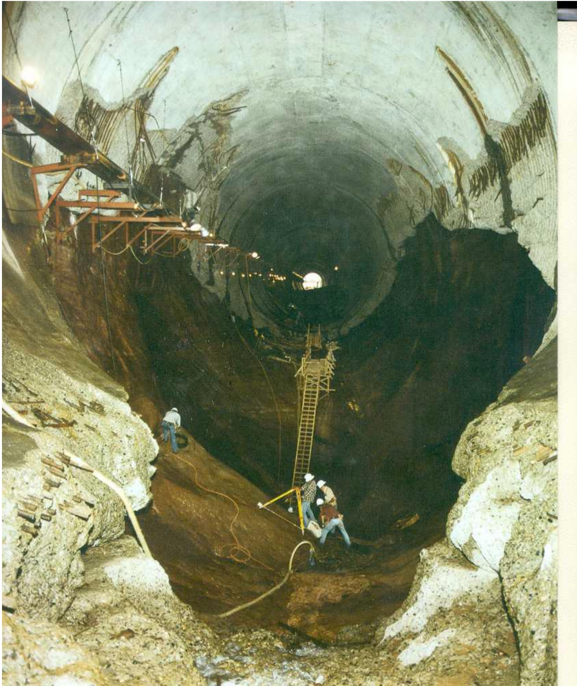
Figura I-6 Presa Glen Canyon. Túnel izquierdo del vertedor Sept. 1983. El “gran agujero” en el vertedor tenía 11 metros de profundidad (Falvey H. T., 1990).
