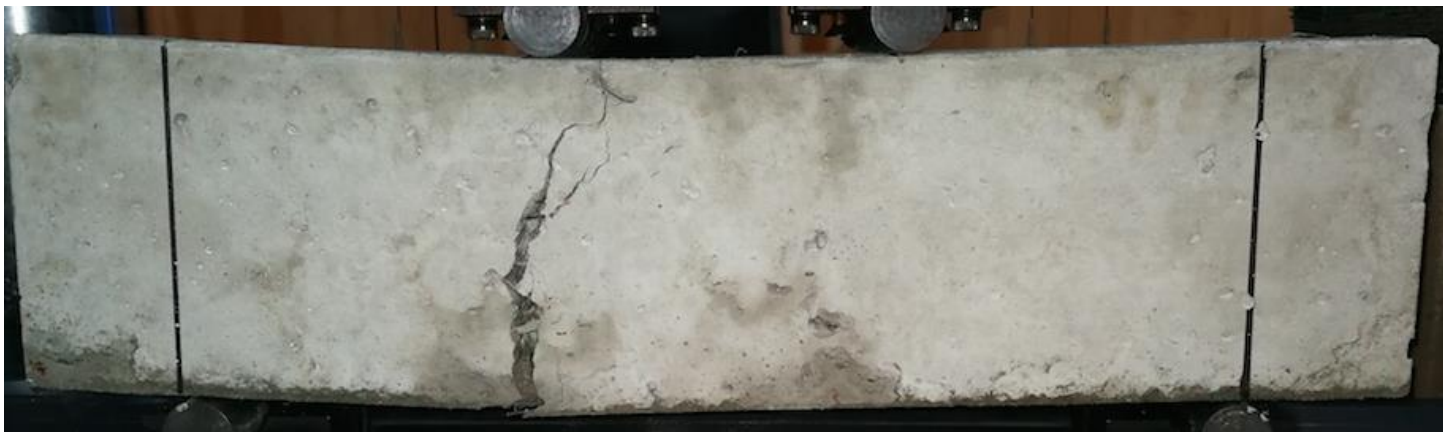
Falla en viga con 2% de fibra grande
