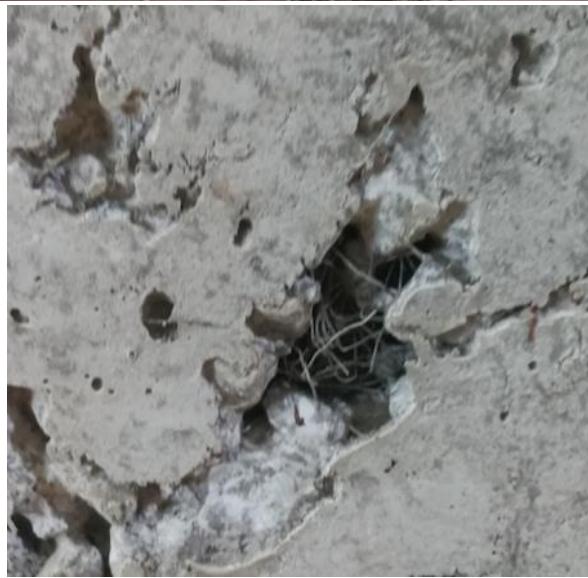
Erizos contenidos en vigas
