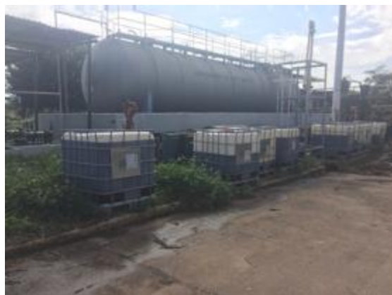
Figura II.10. Tanque de almacenamiento D-607.
