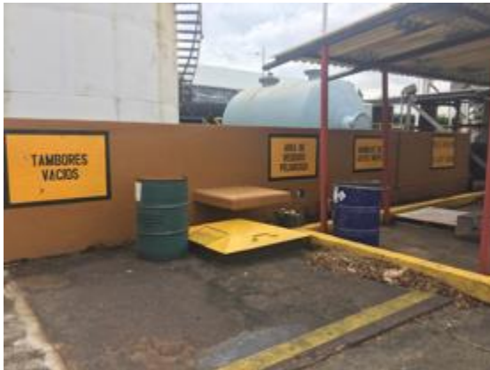
Figura II.4. Área de transferencia de residuos peligrosos del área de Turbogeneradores. Fuente: Complejo Petroquímico Cosoleacaque.
