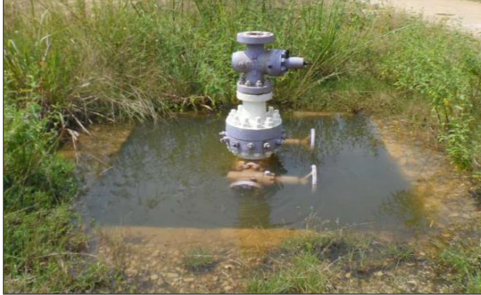
Figura 2.12 Instalaciones superficiales del pozo B.
