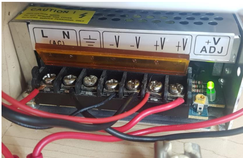
Figura 25. Ejemplo de mala conexión eléctrica de fuente de alimentación, sin conductores de alimentación identificados ni conexión a tierra.
