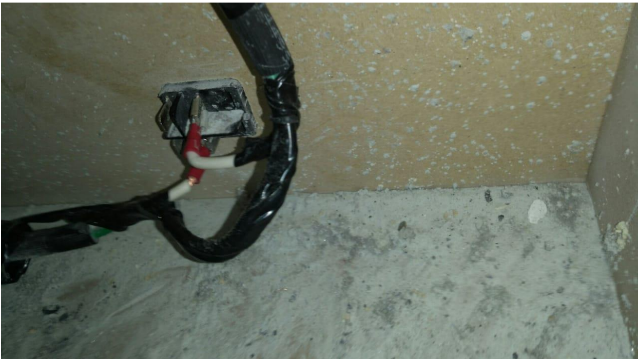
Figura 10. Ejemplo de empalme deficiente con cinta de aislar en mobiliario.
