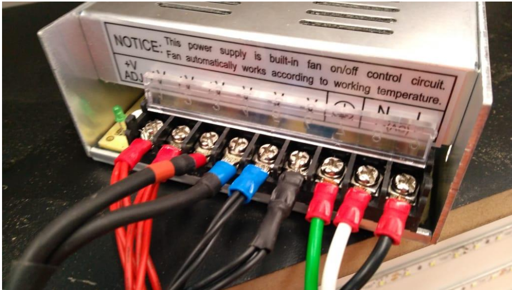
Figura 26. Ejemplo de conexión correcta de una fuente de alimentación para tiras LED.
