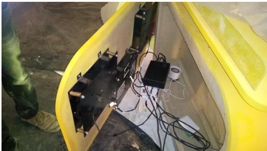
Figura 15. Ejemplo de instalación eléctrica en mobiliario sin uso de canalizaciones.
