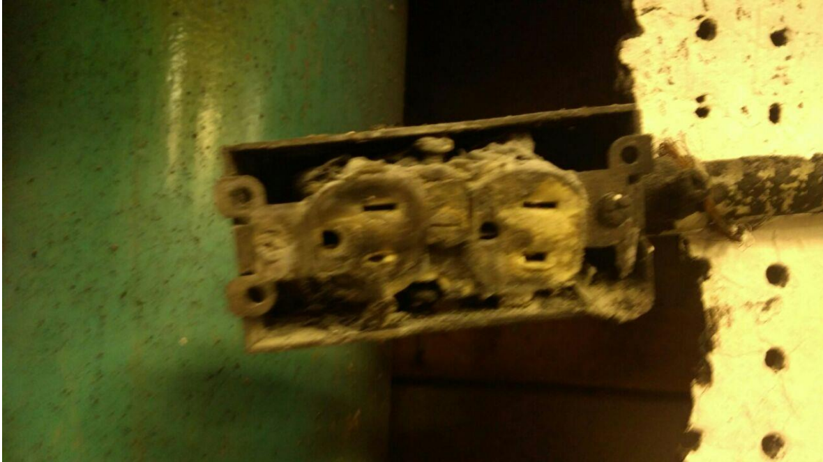
Figura 3. Contactos de servicio dañados en conato de incendio.
