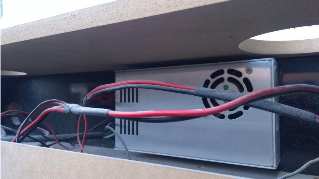
Figura 9. Ejemplo de conexión eléctrica en mobiliario sin canalización.
