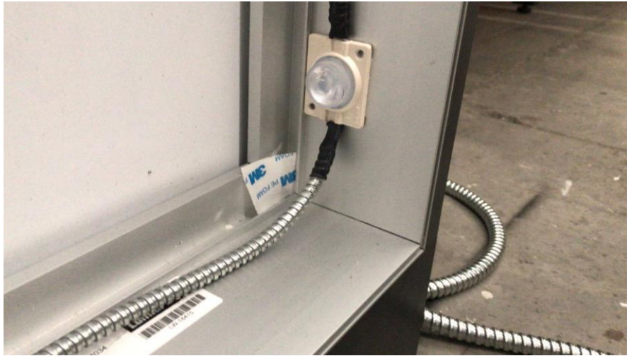
Figura 17. Ejemplo de conexión con termo retráctil para un correcto aislamiento de la instalación.
