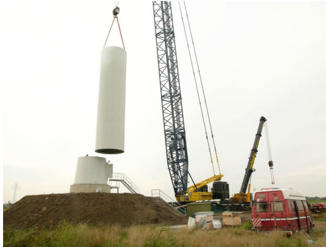
Figura 9.3: Instalación de una torre para un aerogenerador en el parque eólico “Bremerhaven”, Bremerhaven, Bremen, Alemania. Fuente: Hannes Grobe, 2007.
