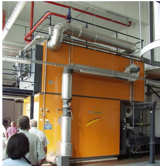
Figura 5.0: Caldera de combustión de biomasa en una central térmica, Lübeck, Alemania. Fuente: Florian Gerlach.
