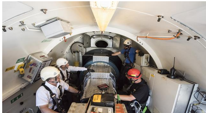
Figura 9.4: Dentro de la góndola de un aerogenerador de 2.3 MW, EUA. Fuente: National Renewable Energy Lab, 2017.
