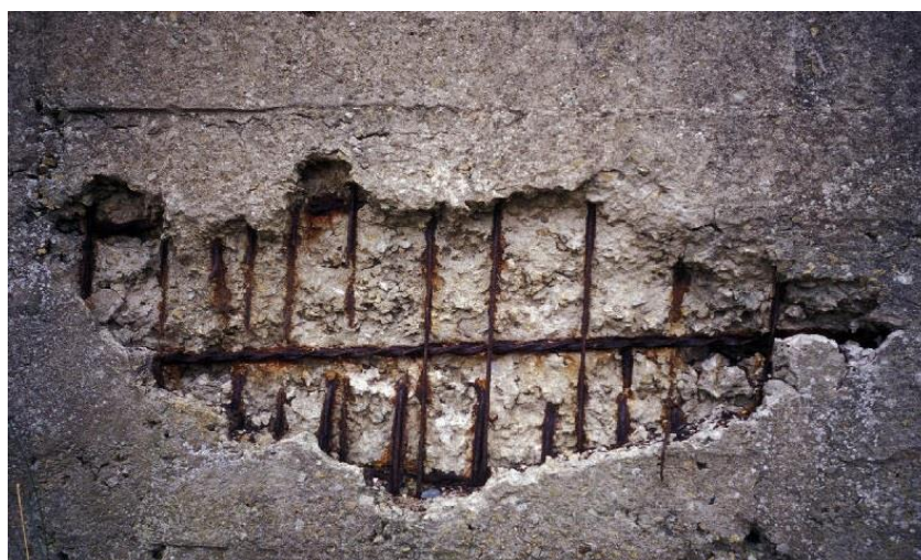
Imagen 3-2. Corrosión en el concreto armado. 23
