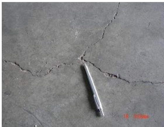
Imagen 3-1. Agrietamiento en el concreto por presencia de contracciones. 22
