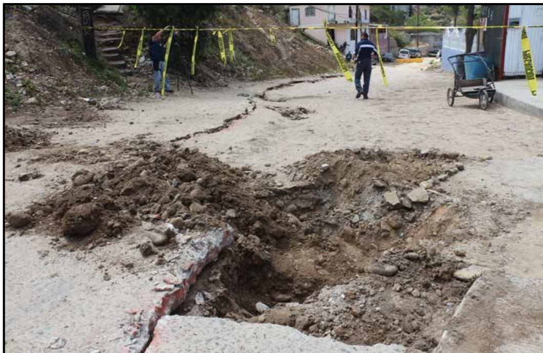
Figura 26. Problema generado por una fuga de agua en la colonia anexa Miramar, Tijuana, B.C (Elenes, 2015).
