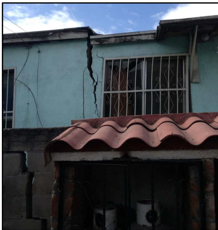
Figura 33. Daños reflejados en una vivienda de la colonia Sánchez Taboada (Proporcionada por la Dirección de Protección Civil Municipal).
