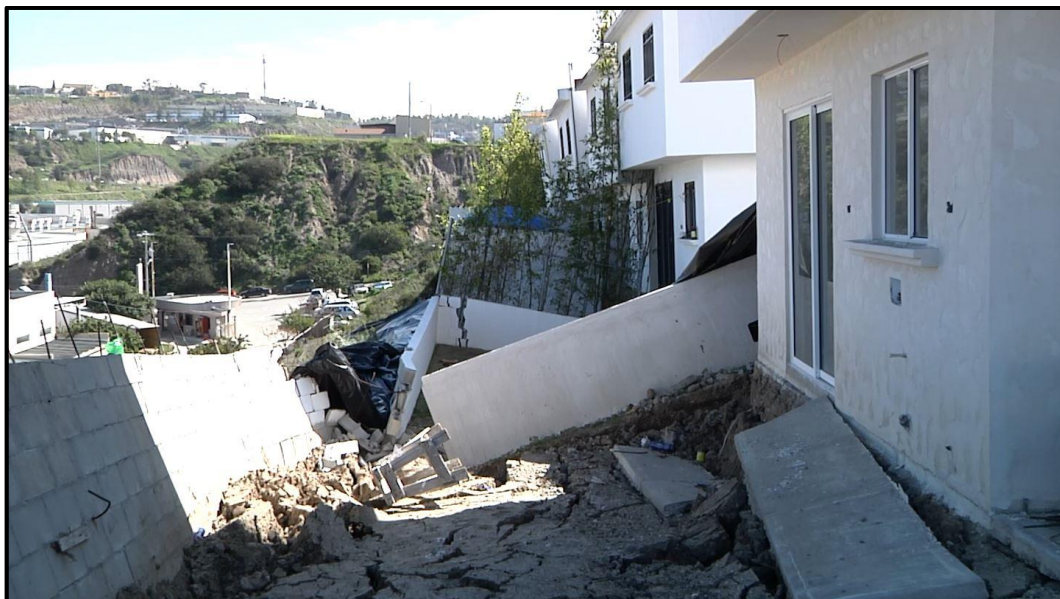
Figura 5. Daño en las casas del Fraccionamiento Valle Sur, Tijuana, Baja California (Corvera, 2017).
