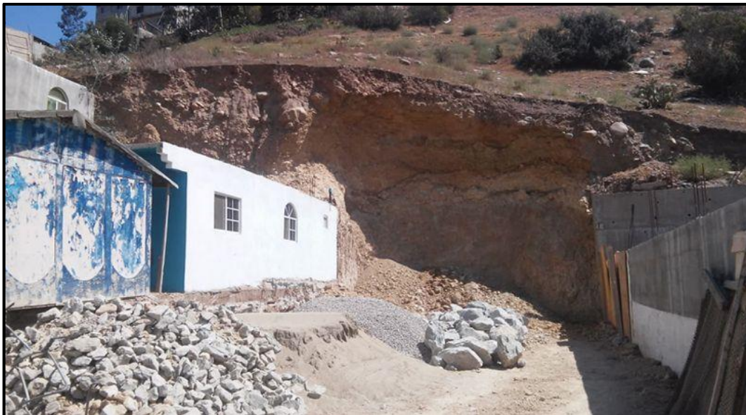
Figura 27. Corte al pie de una ladera en la colonia Pedregal de Matamoros, Tijuana, B.C. Producto de dicho trabajo irregular y sin supervisión resultaron 5 viviendas dañadas en septiembre 2018 (Uniradio, 2018).
