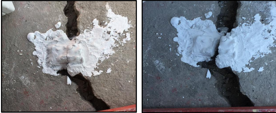
Figura 42. Testigo colocado en la colonia Reforma de la ciudad de Tijuana. En la imagen de la derecha se puede observar el movimiento de la grieta reflejado en el testigo.
