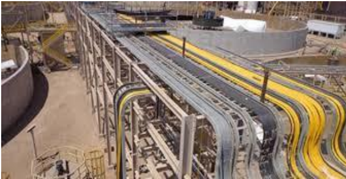
Forma clásica de la estructura de un Rack de Tuberías de Acero.
