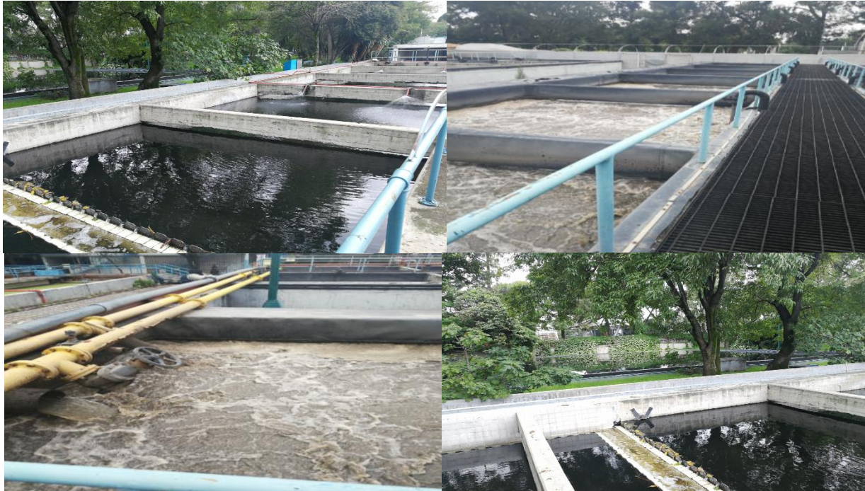
Figura 26 PTAR Ciudad deportiva
