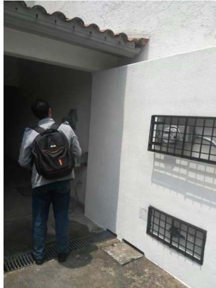
Imagen 2.1 - Centros de carga y medidor del suministrador: aporte propio.
