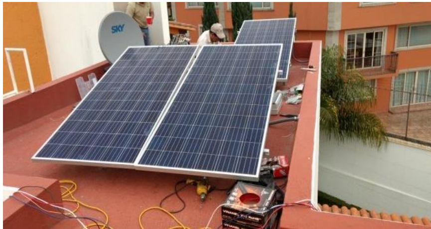
Imagen 3.15 – montaje de grupos de módulos en vertical: aporte propio.
