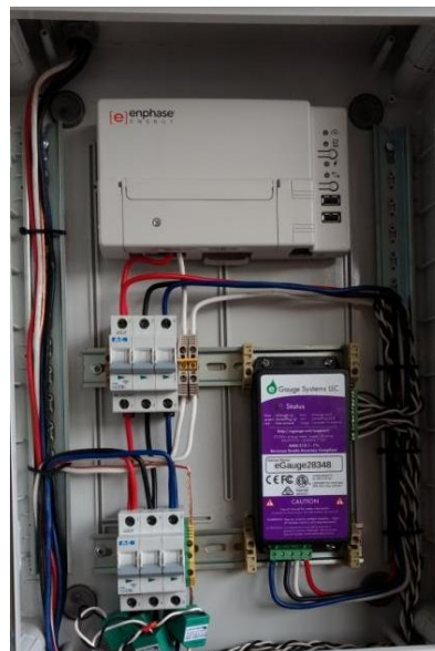
Imagen 3.10 – Cableado de sistemas de monitoreo y protecciones del GFV: aporte propio.
