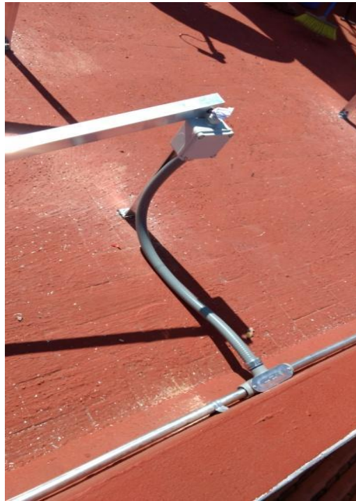
Imagen 3.7 – Canalización hacia la caja de derivación: aporte propio.
