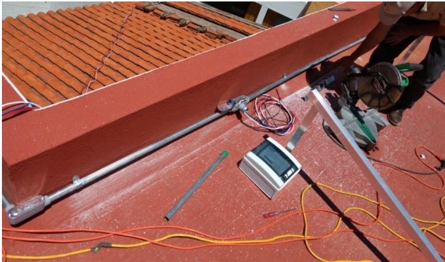
Imagen 3.6 – Canalización hasta la caja combinadora: aporte propio.
