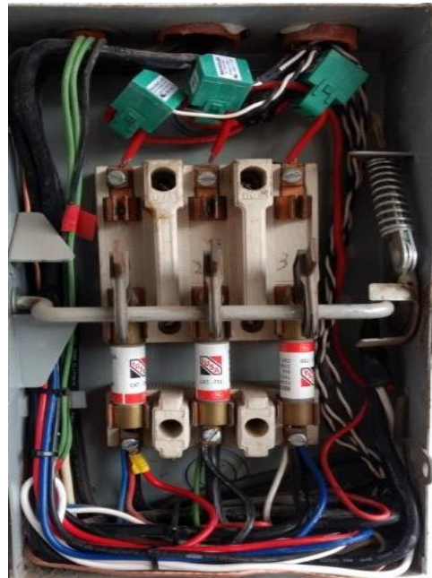
Imagen 3.11 – Instalación de CT's de corriente: aporte propio
