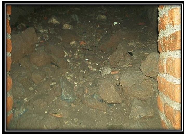
Desechos de construcción dentro de la cavidad
