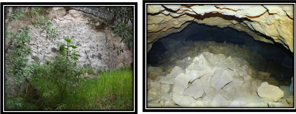
Figura 8. Mina tapada y asentamiento de muro de vivienda e interior techo colapsado
