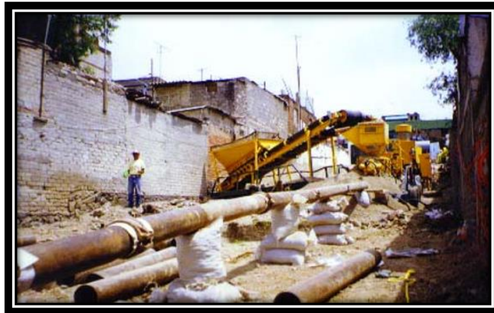
Figura 19. Equipo para bombeo del fluido para el sello en las costaleras
