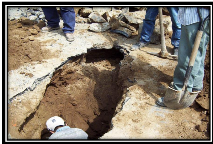
Hundimiento del terreno sobre la calle desplome del techo de la caverna existente en la calle.
