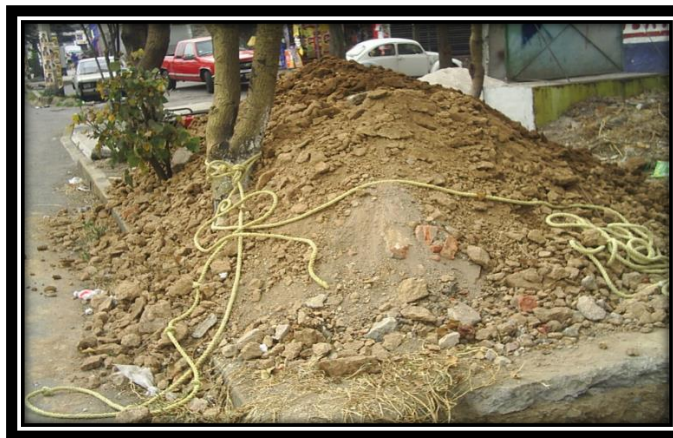
Material producto de la excavacion de la lumbrera para acceso a la caverna.
