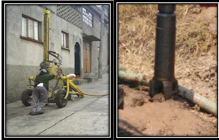
Figura 11. Equipo de perforación simple neumático
