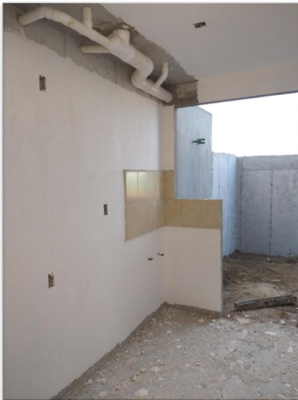
Figura No. 47 – Instalaciones sanitarias debajo de baños.
