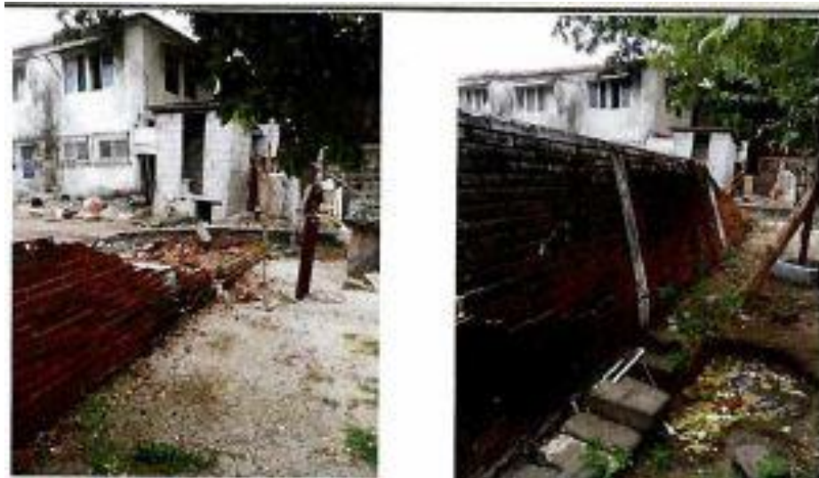
Figura 3.29 - Colapso parcial o total de bardas.
