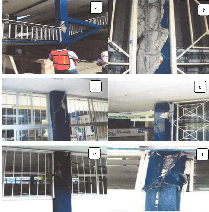
Figura 4.6 - Daños algunos daños de edificios demolidos (fotos: INIFED).
