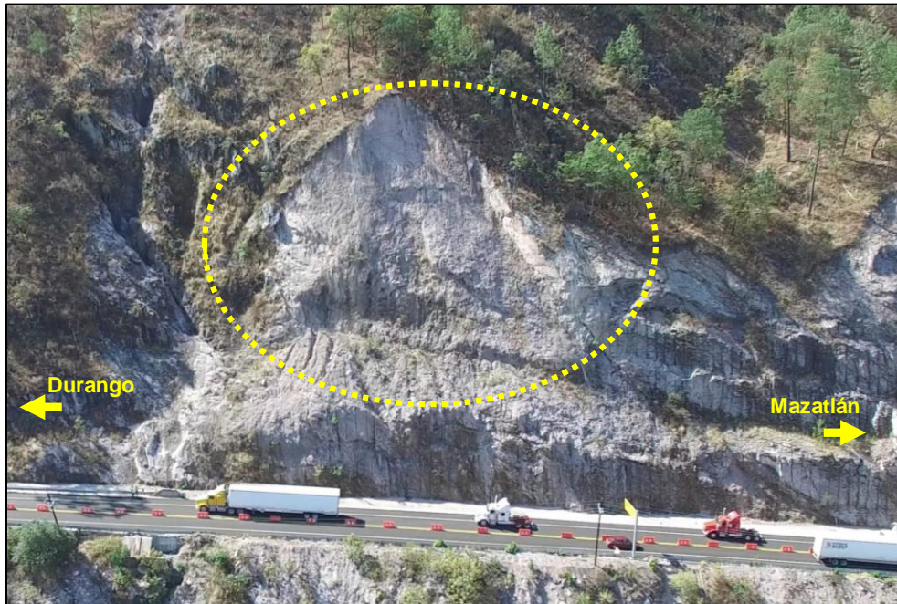
Fotografía 1.3. Zona del corte con presencia de malla de triple torsión (círculo amarillo); la malla está rota y desprendida de la parte inferior
