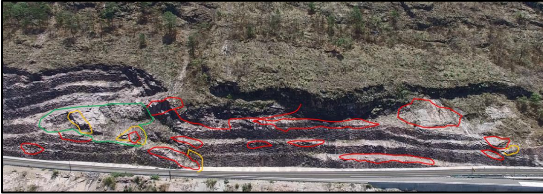
Fotografía 4.19. Panorámica que muestra la diversidad de elementos inestables en el corte en la porción noreste
