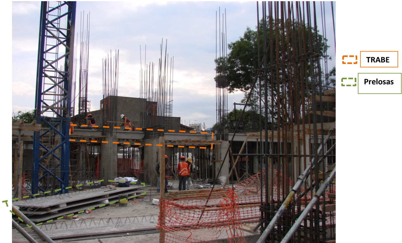
Figura 2. 22 Fotografía tomada el día 20 de febrero del 2015 Nivel 2, Eje 7 del E al C
