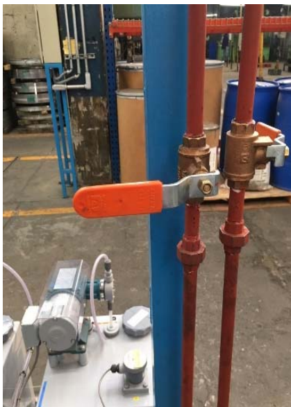
Figura 15 HV-934 (izq.) HV-935 (der.)
