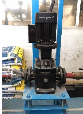
Figura 17 Bomba de recirculación (PUMP-110A)
