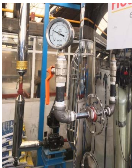
Figura 12 i Manómetro tanque VSSL-900
