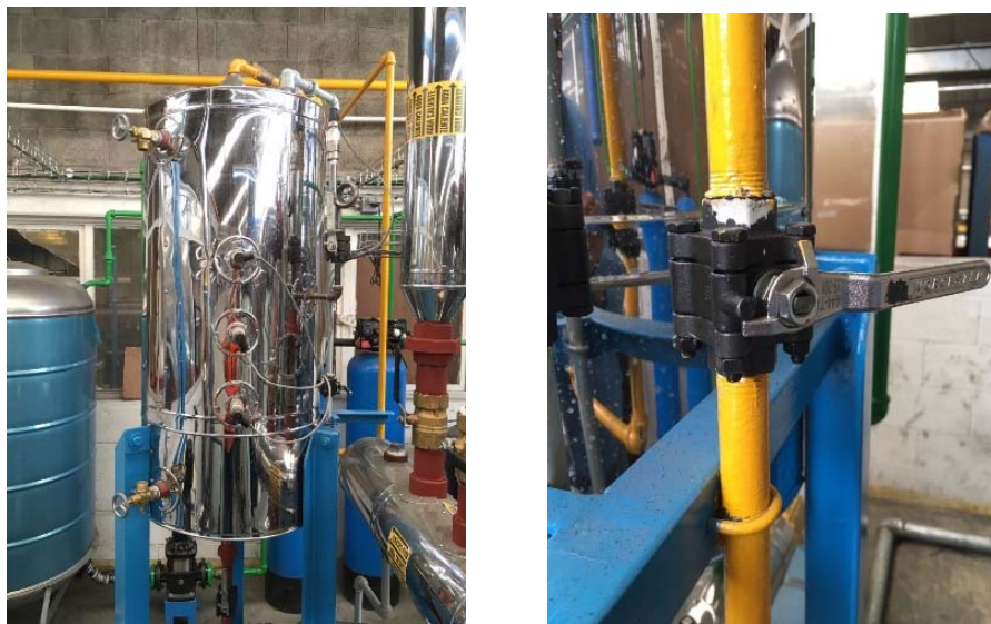
Figura 11 Tanque VSSL-905 (der) y HV-906 (izq.)
