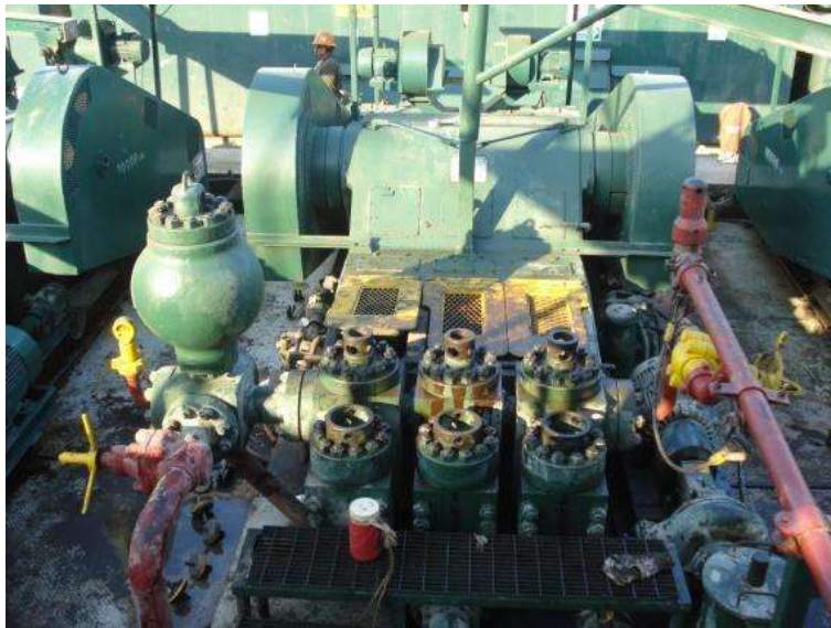
Figura 2.2.1.a. Bombas de lodo Fuente: Extraído de [3]
