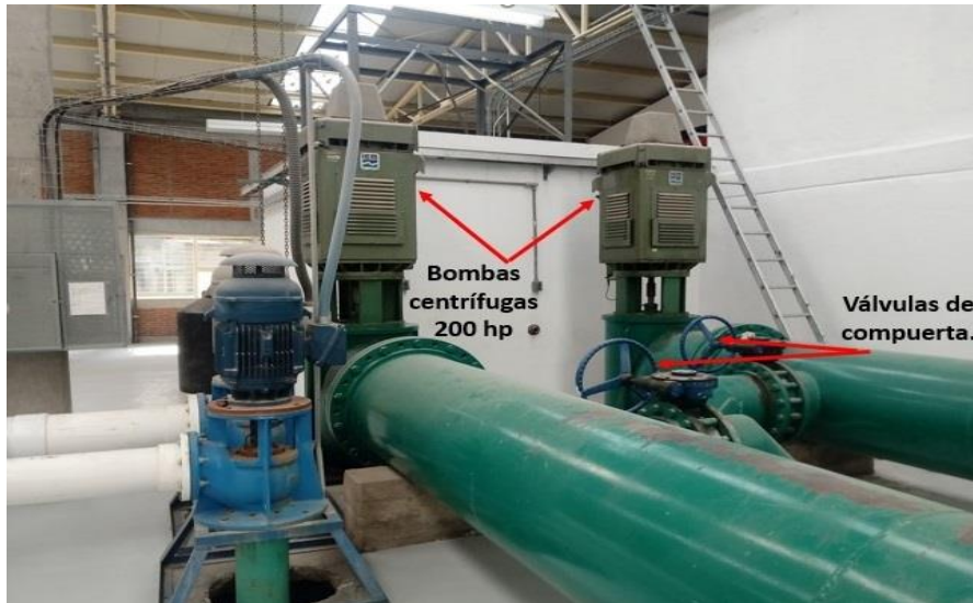
Figura 4.7. Sistema de bombeo del modelo del vertedor
