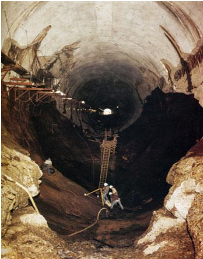
Figura 3.6. Daño por cavitación en el Túnel del vertedor de la presa Glen Canyon, Septiembre de 1983 (Falvey, 1990)
