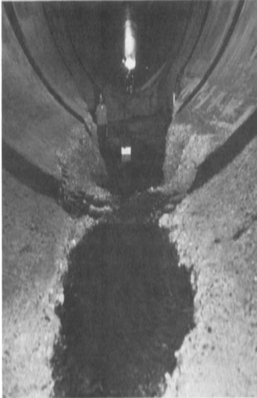
Figura 3.12. Daño por cavitación en el túnel del vertedor de la presa Yellowtail (Arndt, 2003)
