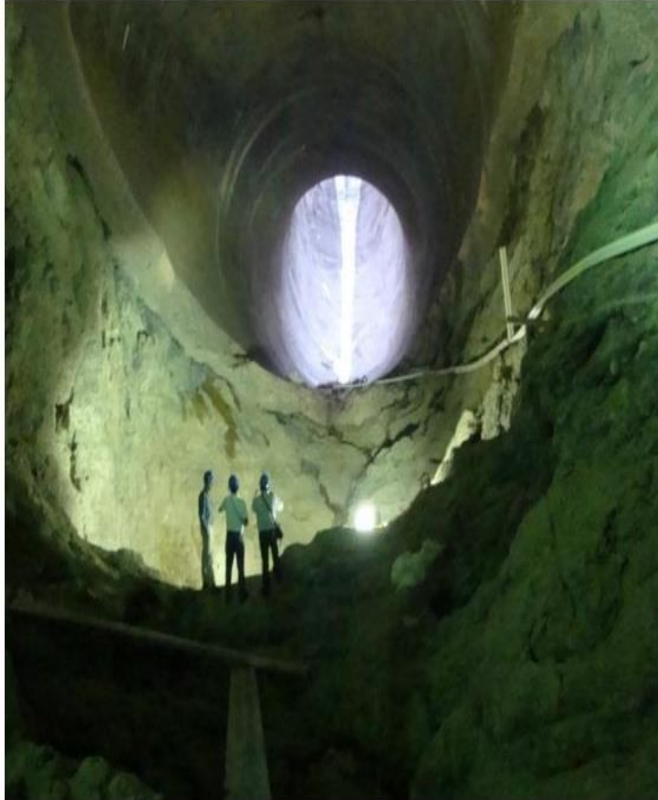
Figura 3.8. Daño por cavitación en uno de los túneles de la presa Infiernillo (Gómez Arteaga, 2016)
