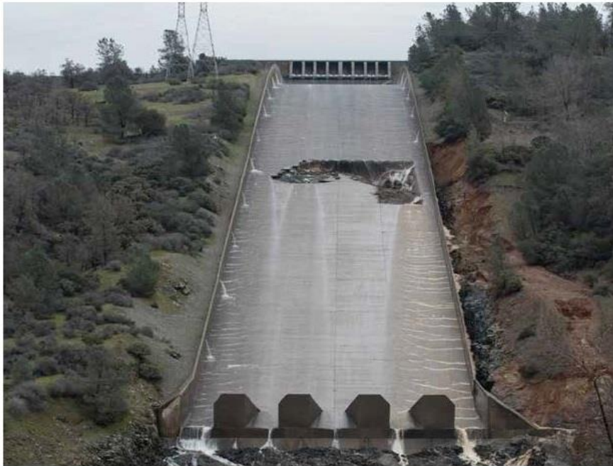
Figura 3.9. Daños por cavitación en la rápida del vertedor de la presa Oroville (Sandoval Erazo, 2018)
