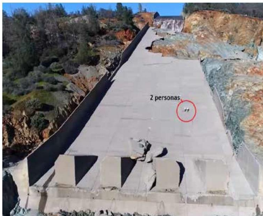
Figura 3.10. Inspección de los daños, debido a la cavitación en la rápida del vertedor de la presa Oroville (Sandoval Erazo, 2018)
