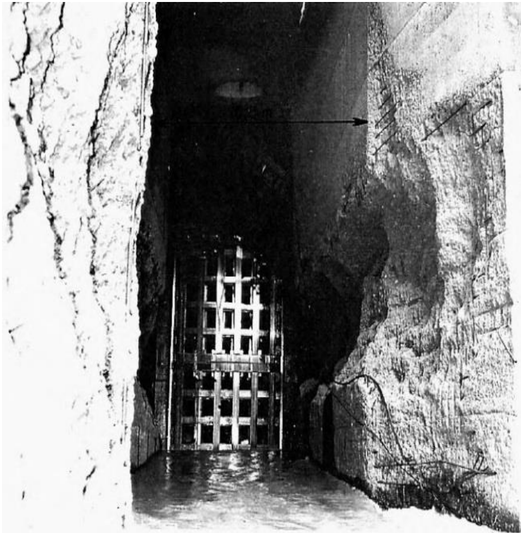
Figura 3.11. Daño por cavitación en uno de los vertedores de la presa Guri (Suárez Barrera,1997)
