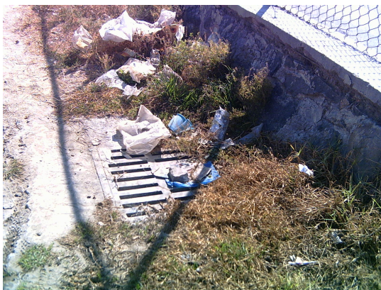
Figura 3.19 Cárcamo de Bombeo
