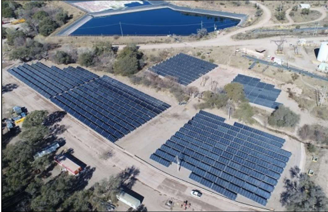
Figura 19. Planta termosolar unidad Milpillas
