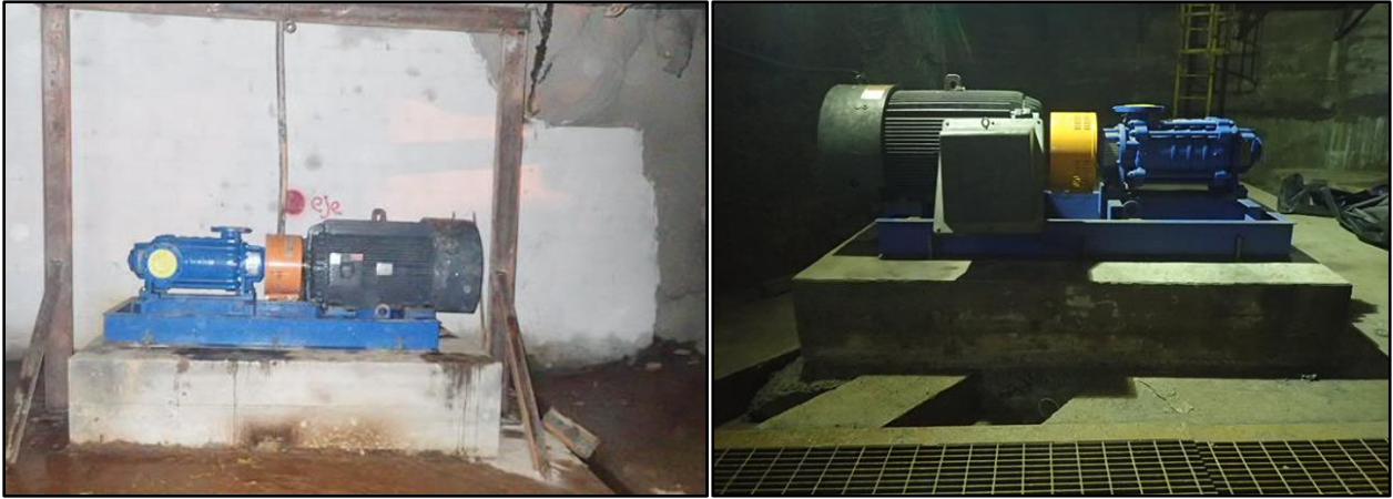
Figuras 99 y 100. Bombas instaladas en nivel 790 y 1160 respectivamente
