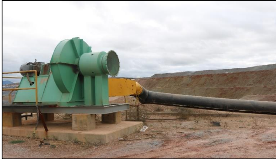
Figura 13. Sopladores instalados en patios
