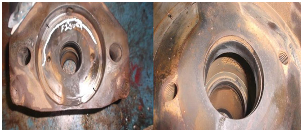
Figura 22. Desgaste de la nariz de la perforadora del jumbo anclador # 09 (03 abr 2016)
