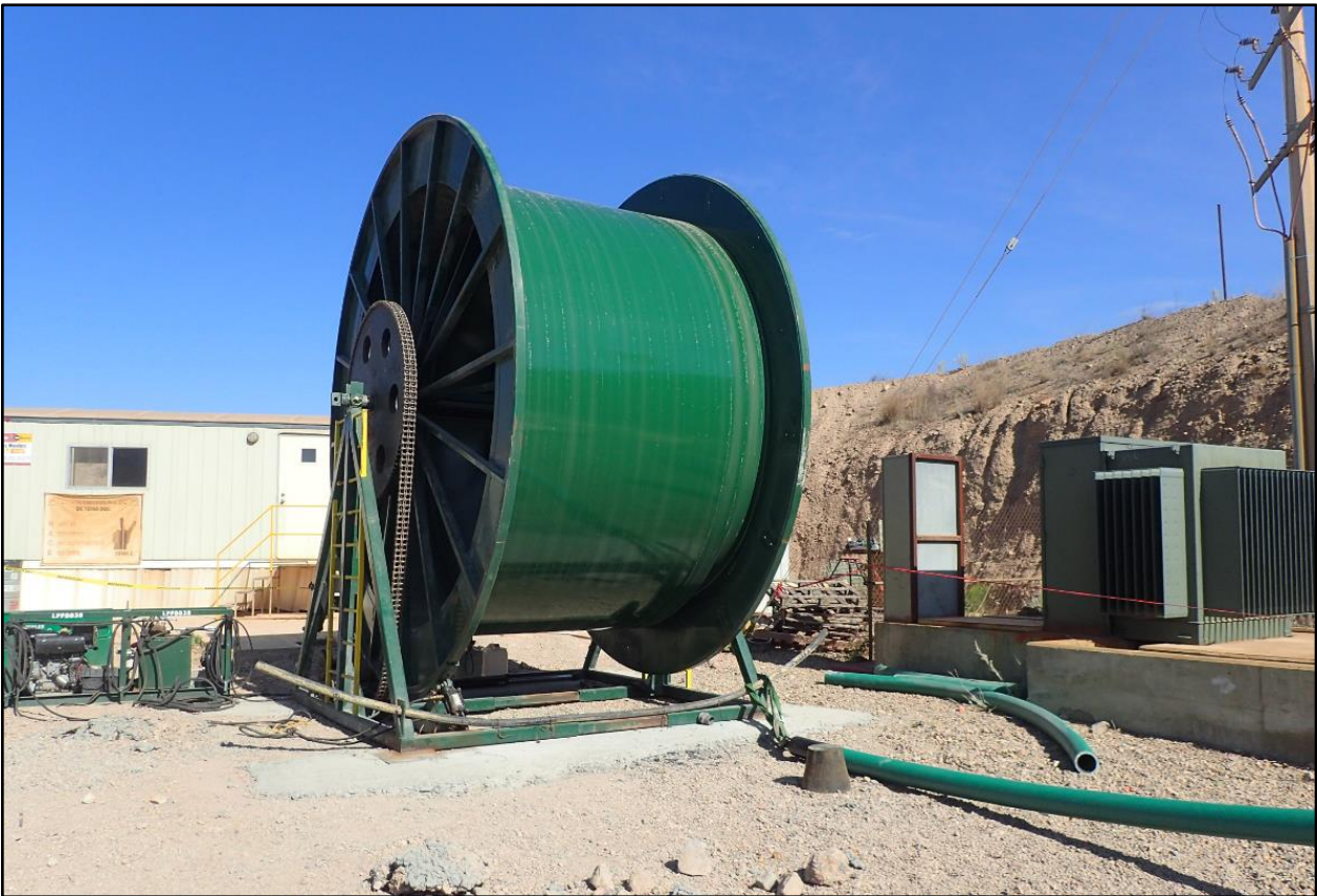
Figura 67. Se termina de bajar la tubería de fibra de vidrio del primer carrete
