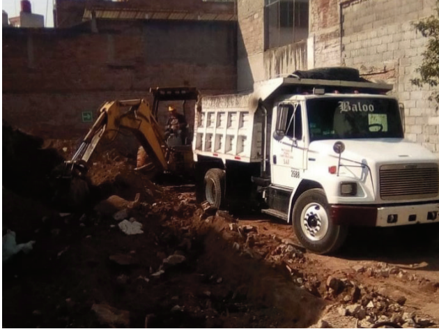
Excavación por medio mecánicos y acarreo de materiales producto de la excavación.
