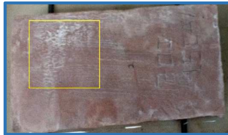
Figura 5.15 Ladrillo con eflorescencias
