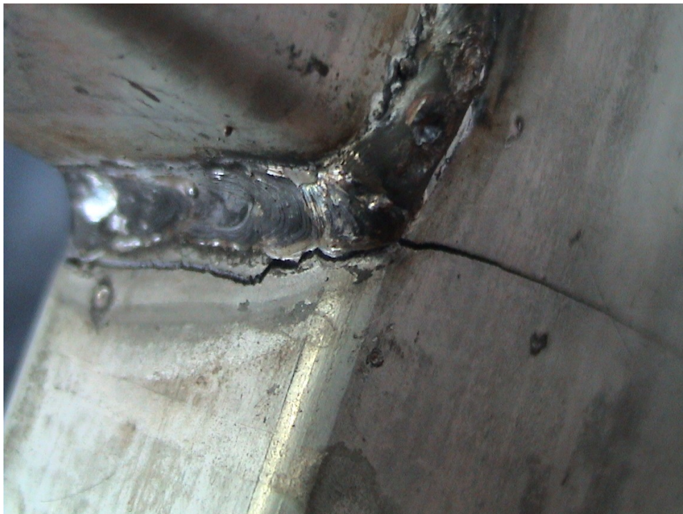
Figura 4-27. Grieta obtenida (acercamiento).
