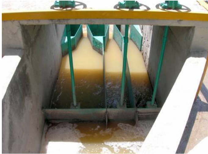
Figura 32. Salida del desarenador.
