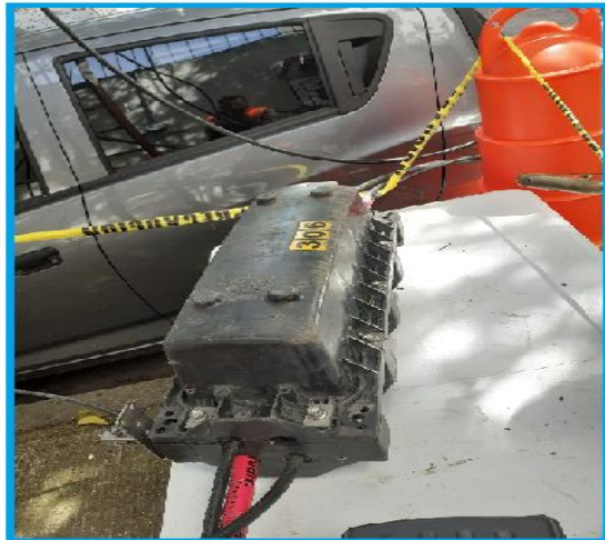
Figura 30. Caja de Acometida. Fuente: Intranet. Datos propios de la empresa.
