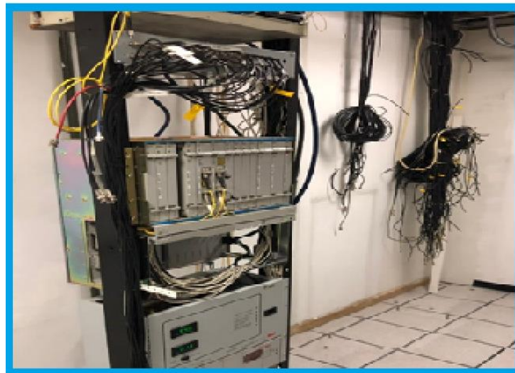
Figura 17. Afectación por el usuario. Después de reubicar el equipo. Fuente: Intranet. Datos propios de la empresa.
